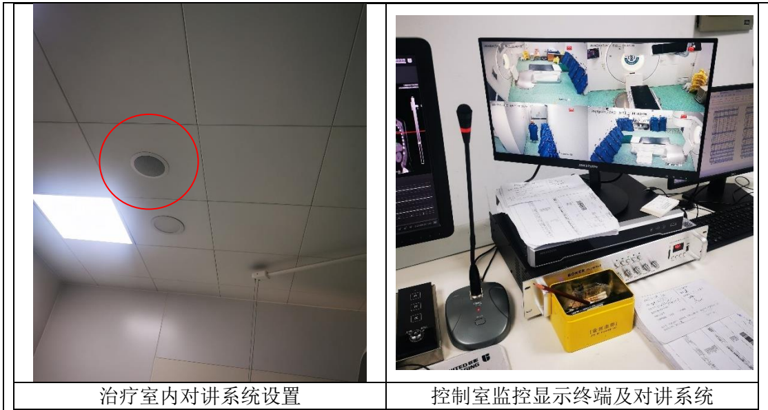
图 3-4 本项目加速器机房视频监控装置及对讲系统设置
