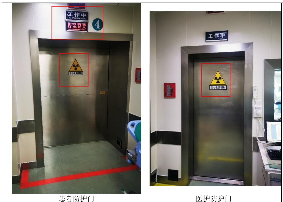
图 3-9 本项目 4#DSA 机房电离辐射警告标志及工作状态指示灯
