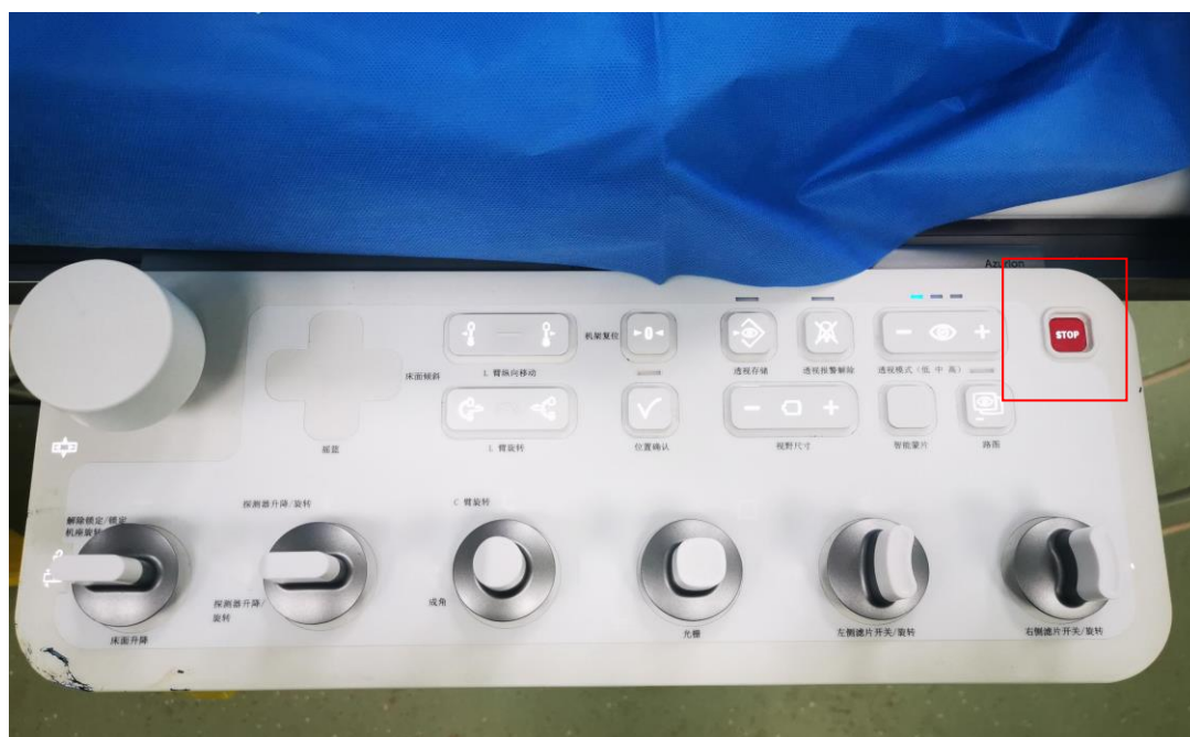
图3-11 本项目DSA机房内病床上急停按钮
