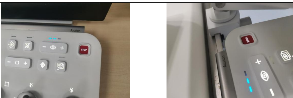
图3-4 本项目 DSA 机房控制室及机房内设备操作面板上急停按钮
