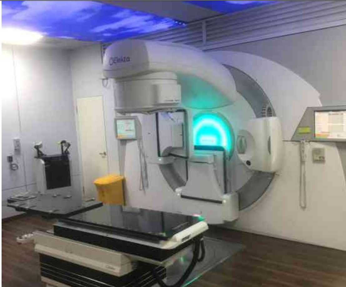
图 2-1 本项目医用直线加速器设备外观图
