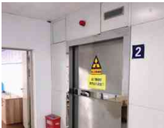
（a）2号直线加速器机房防护门
