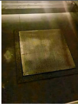
2#加速器辐照窗下排风口
