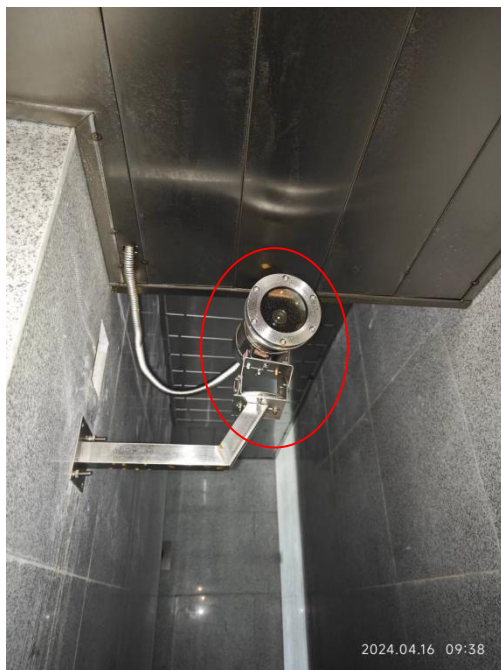
2#加速器机房辐照室迷道口摄像头
