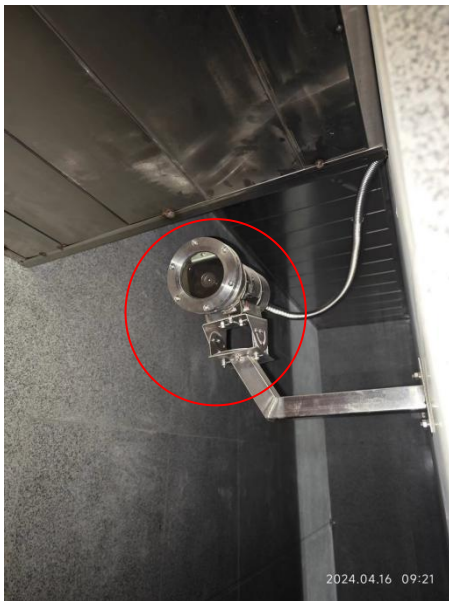
1#加速器机房辐照室迷道口摄像头
