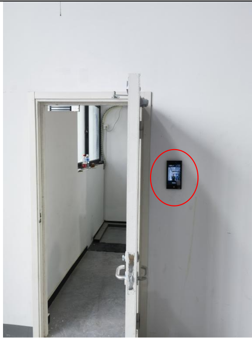
1#加速器控制室门禁
