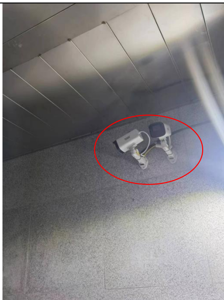
1#加速器机房辐照室迷道内摄像头
