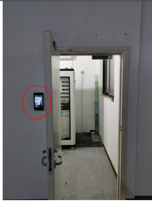
2#加速器控制室门禁
