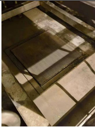
1#加速器辐照窗下排风口
