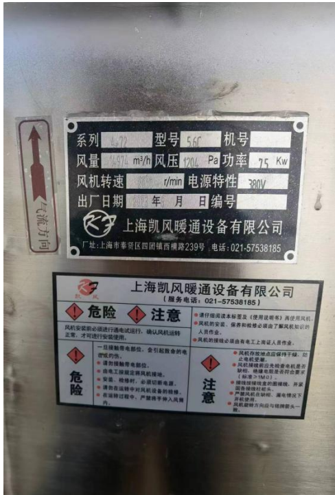
1#加速器配套风机铭牌
