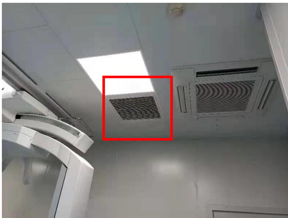
图 3-6 本项目 DSA 机房通风系统
