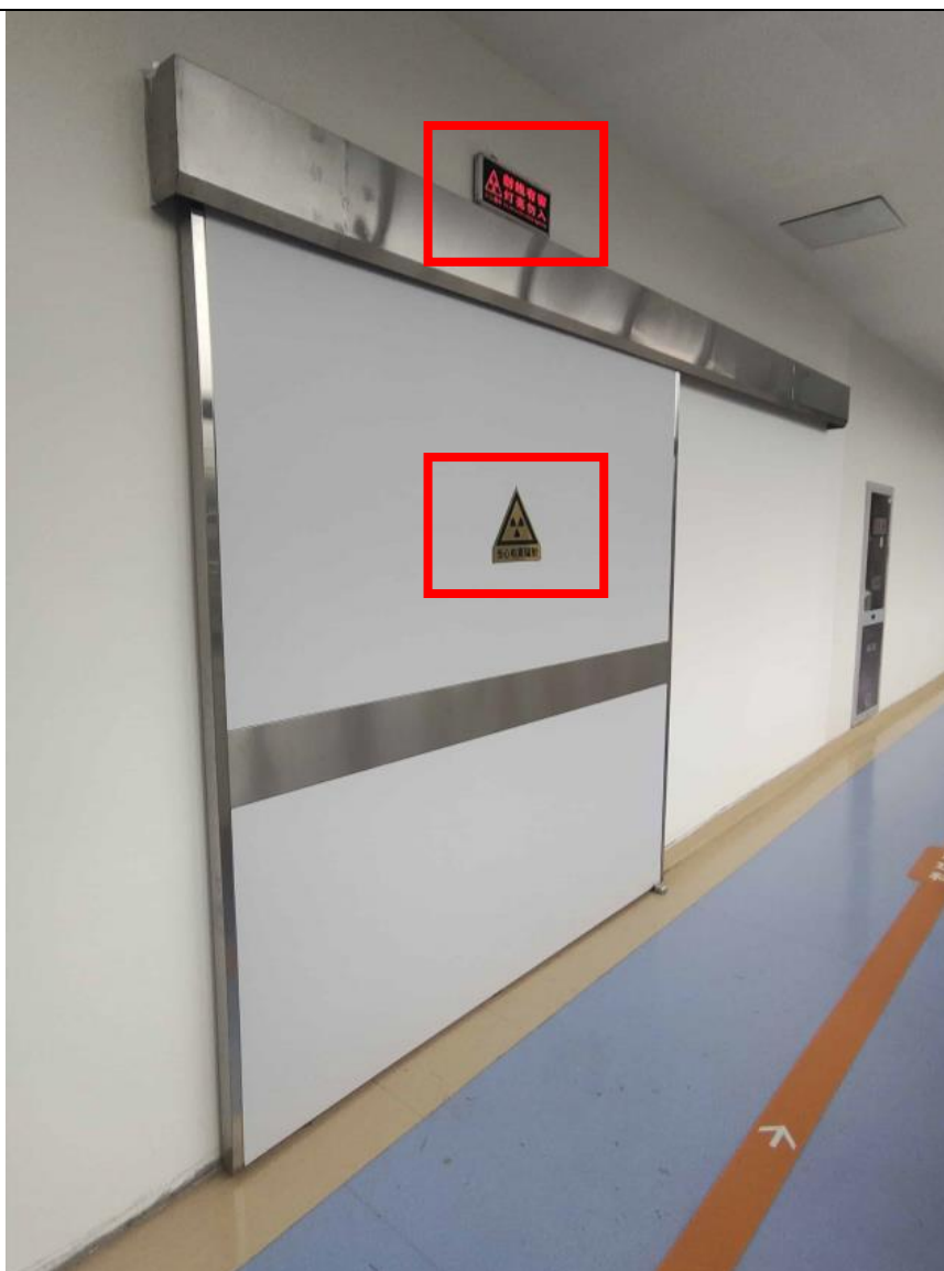
图3-2 本项目DSA机房工作状态指示灯和电离辐射警告标志
