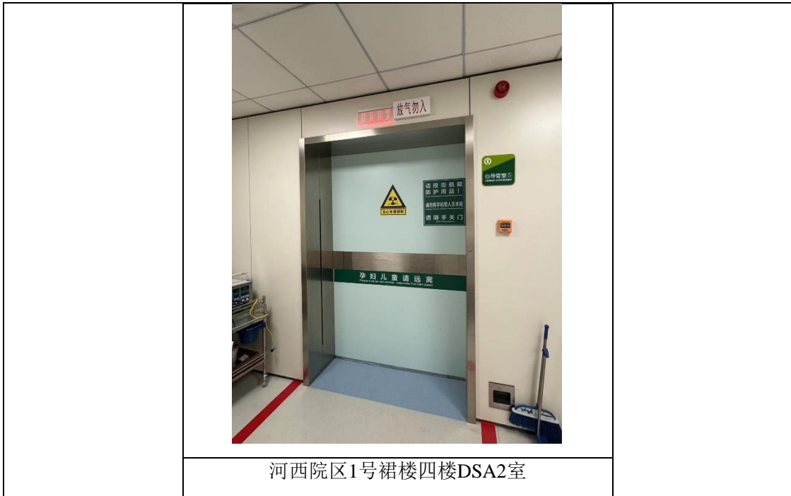
图3-2 本项目DSA机房工作状态指示灯和电离辐射警告标志
