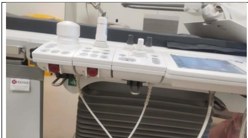
河西院区1号裙楼四楼DSA2室急停按钮
