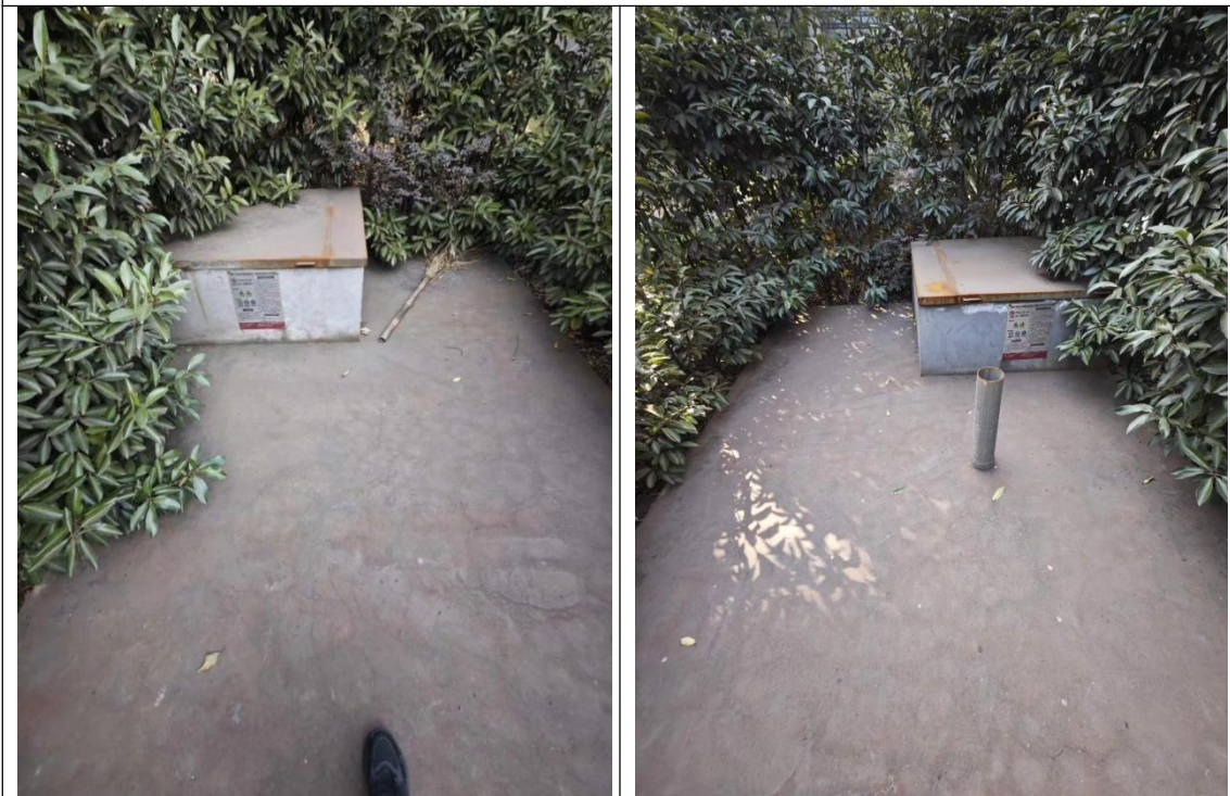
联峰 110kV9#变电所事故油池
