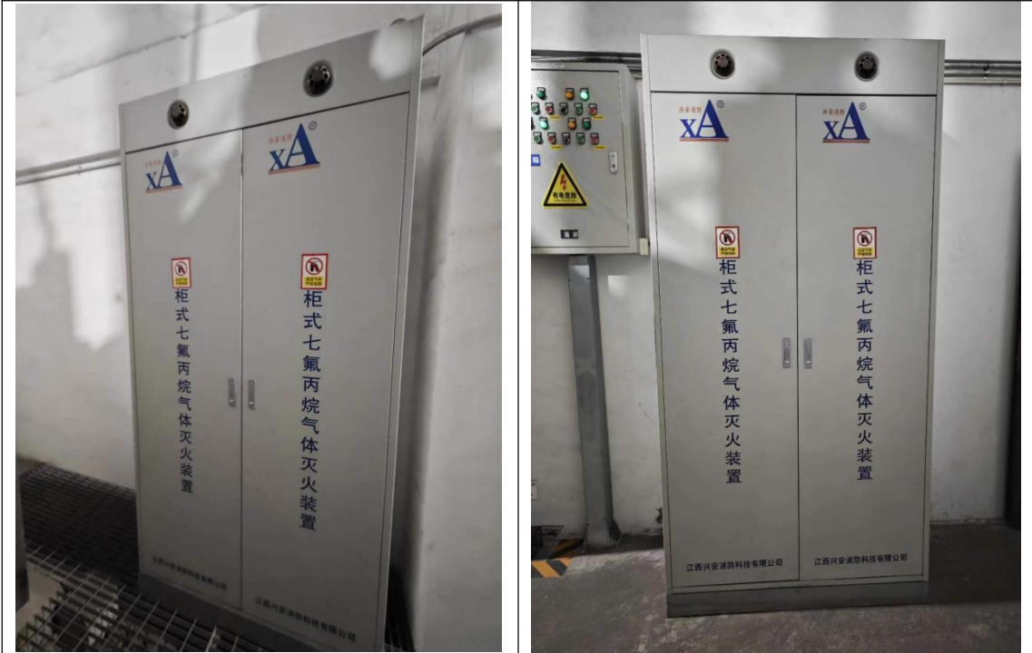
4#主变室内配备的 2 套气体灭火装置
