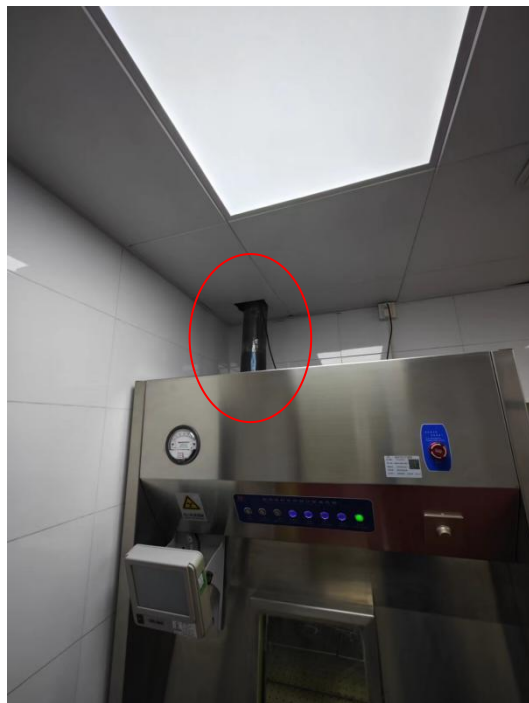
通风橱独立通风管道
