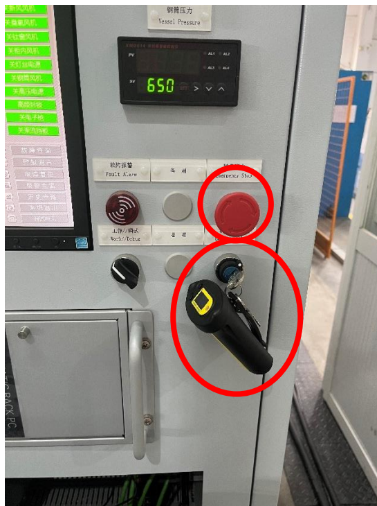
图3-8 2#加速器机房控制柜钥匙开关和急停
