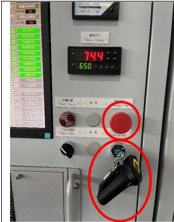
图3-6 2#加速器机房控制柜钥匙开关和急停
