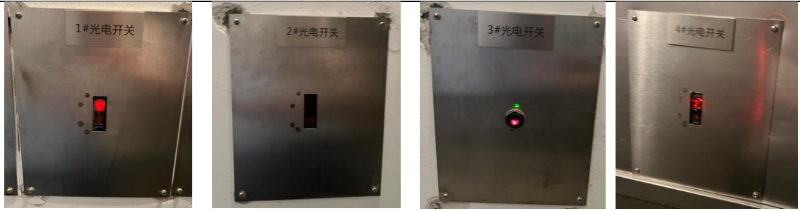
图3-18 3#加速器机房辐照室内防人误入装置
