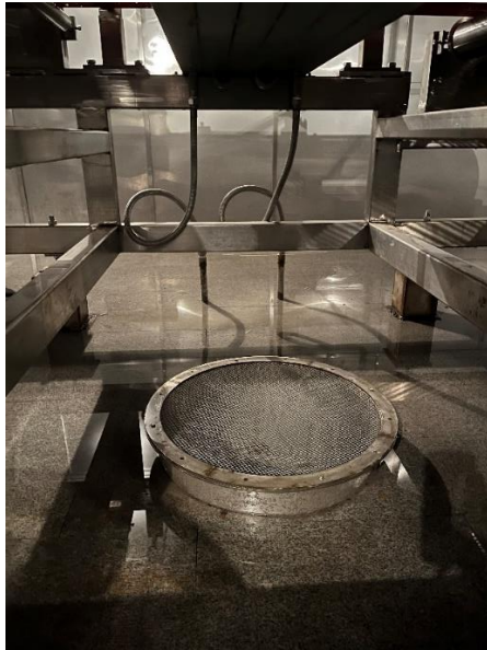
图3-28 2#加速器机房辐照室内排风口
