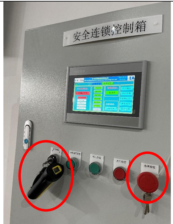
图3-7 2#加速器机房防护门钥匙开关和急停
