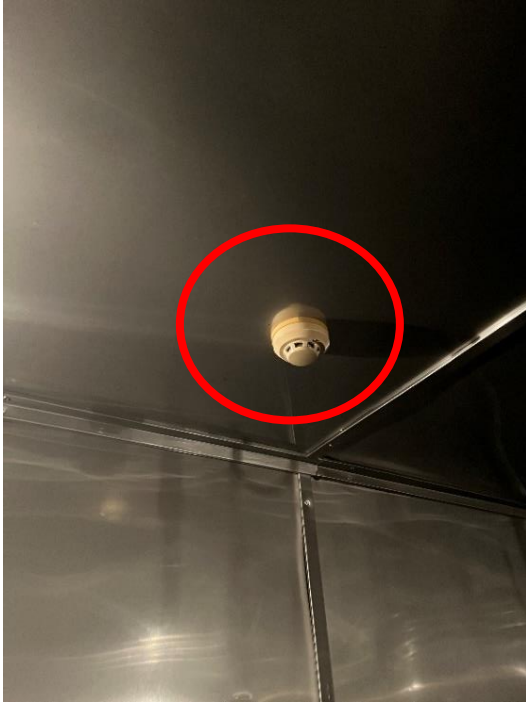
图3-31 2#加速器机房辐照室内烟雾报警器
