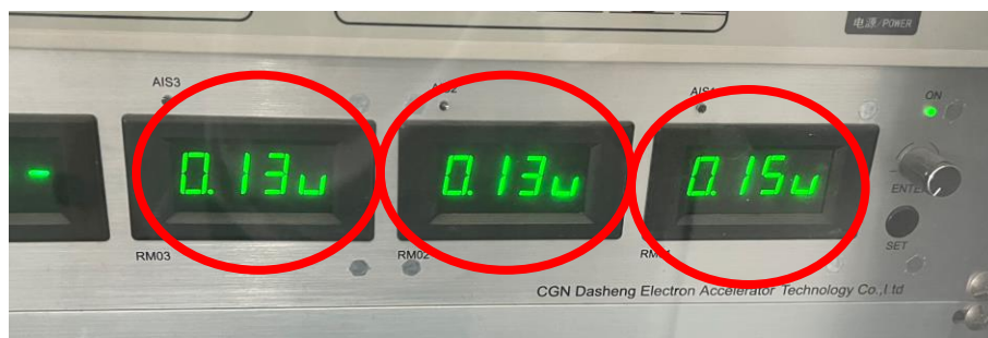
图3-25 2#加速器机房固定式辐射监测系统
