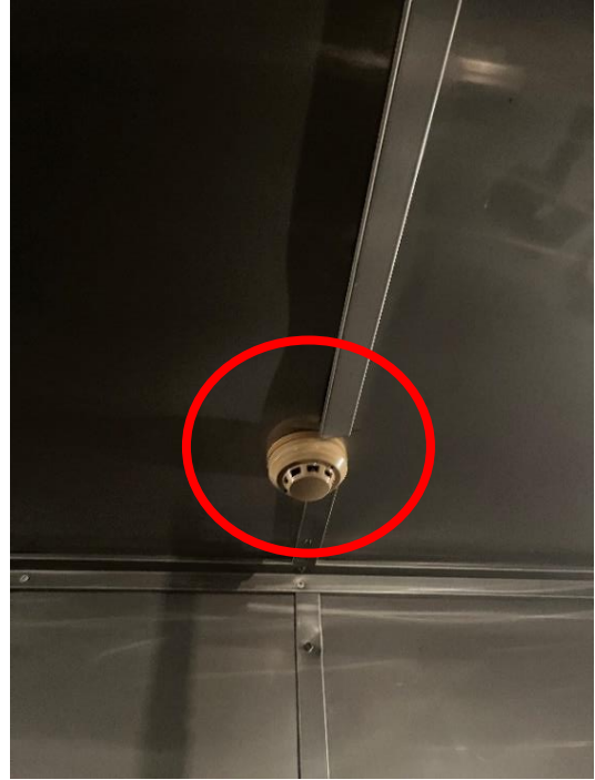
图3-32 3#加速器机房辐照室内烟雾报警器
