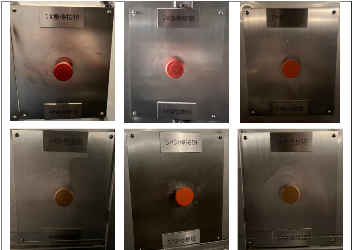
图3-16 3#加速器机房辐照室内巡检/急停按钮
