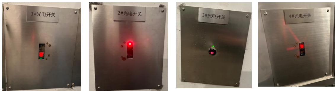
图3-17 2#加速器机房辐照室内防人误入装置
