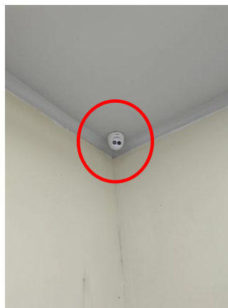
DSA检查室监控
