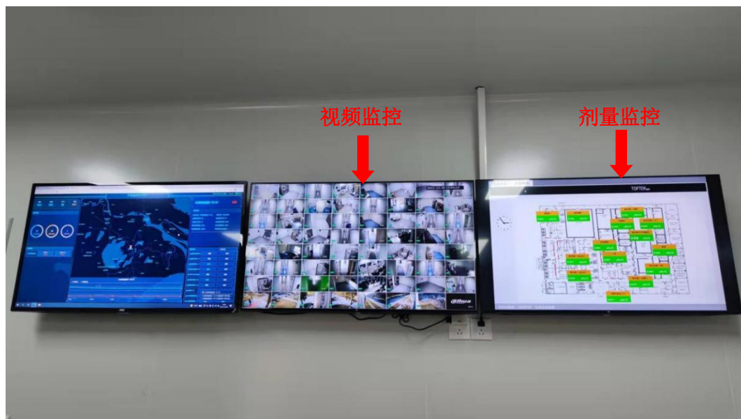
图3-5 视频监控和剂量监测装置
