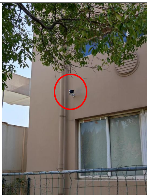
衰变池处监控
