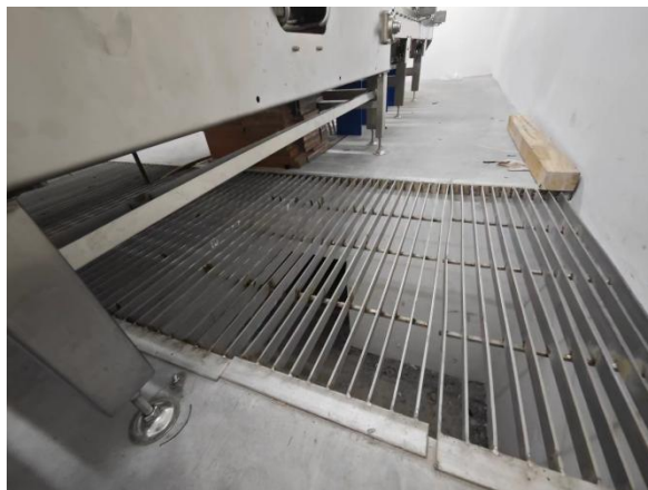
加速器出束口下方排风窗口
