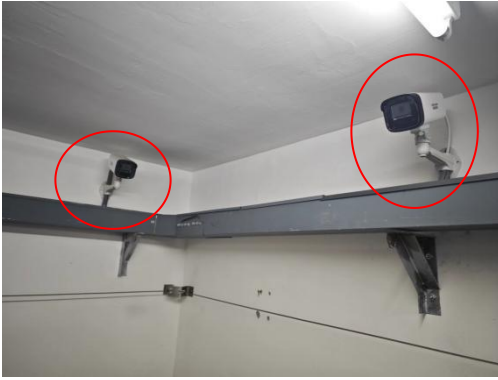
辐照室迷道内监控
