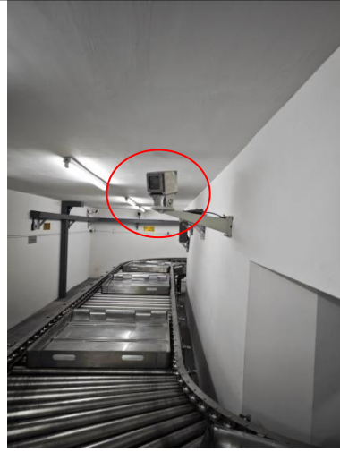
辐照室内监控
