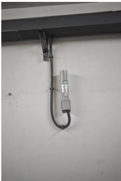
辐照室内固定式剂量监测探头
