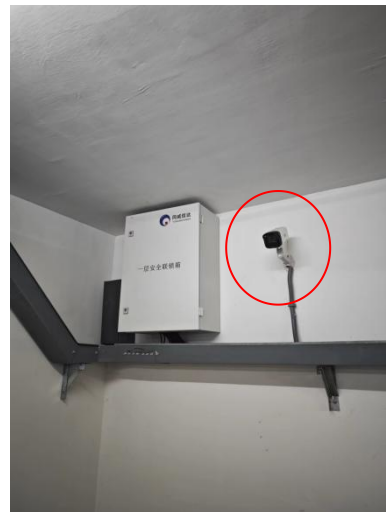
辐照室迷道内监控
