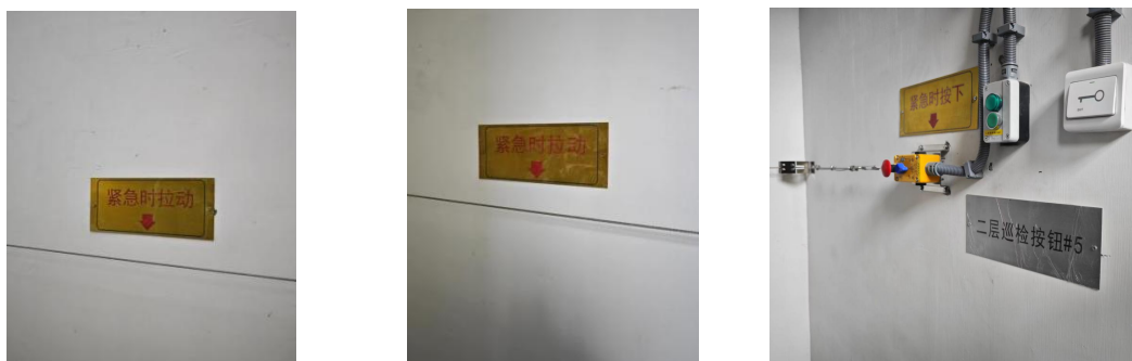
主机室内拉线开关
