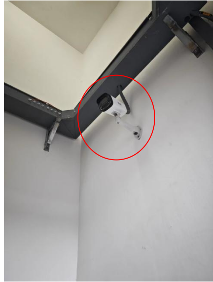
主机室内监控
