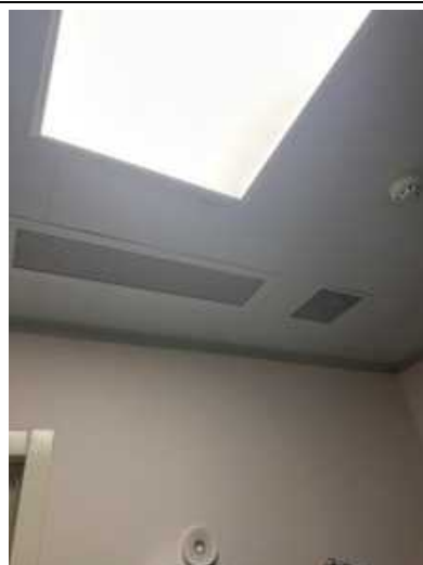
(f) 分装注射室排风
