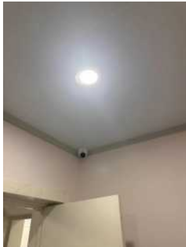
(e) 废物库监控装置
