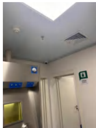
(i) 手套箱排风管道
