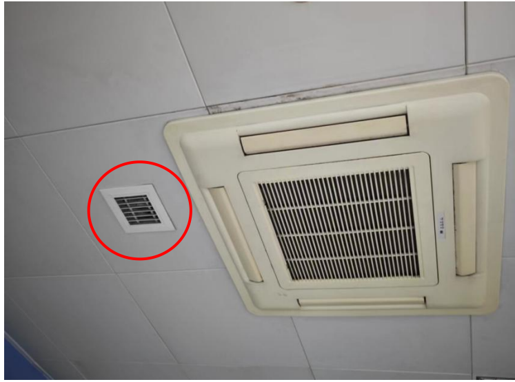
图3-9 ERCP机房内动力通风装置
