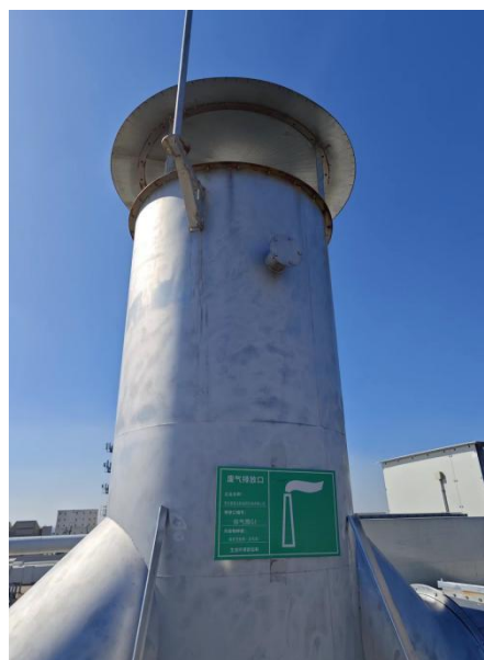
楼顶废气排放口
