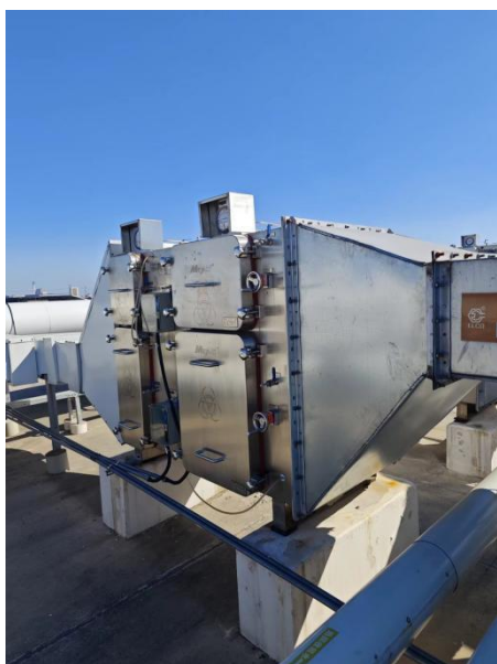
楼顶活性炭过滤装置
