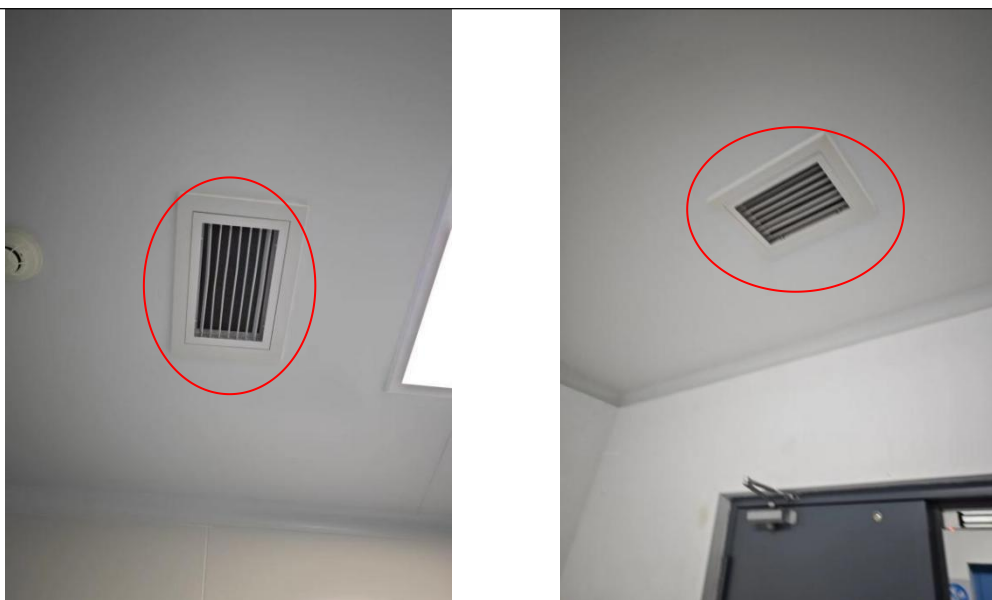
实验室工作场所内通风设施
