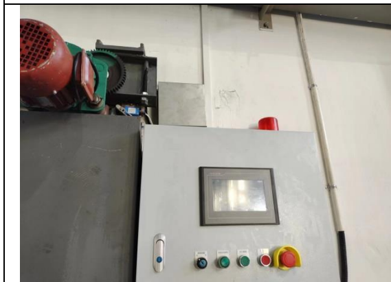
图3-6 本项目巡检按钮和巡检装置
