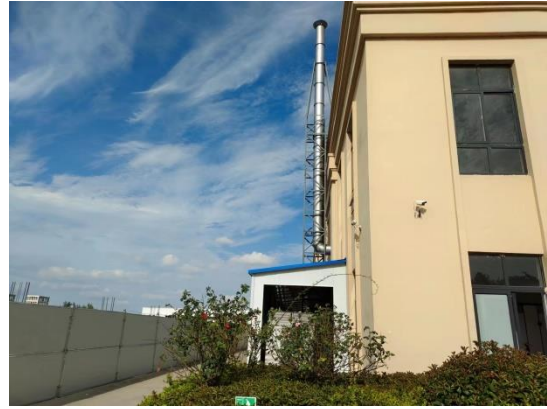
图3-16 本项目室外通风管道
