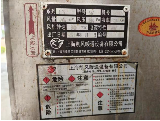
图 3-15 本项目暖通设备铭牌
