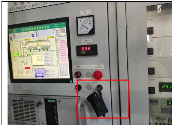
图3-4 本项目工业电子加速器主控钥匙开关
