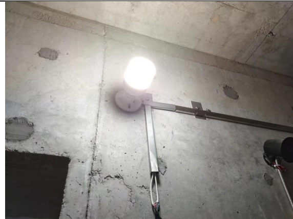
图3-10 本项目辐照室内应急照明灯
