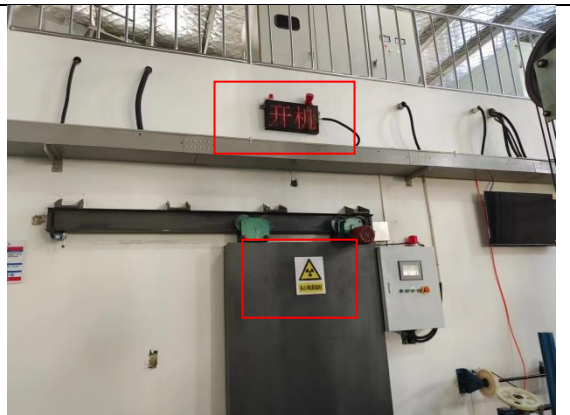
图3-5 本项目加速器辐照室工作状态指示灯与电离辐射标志
