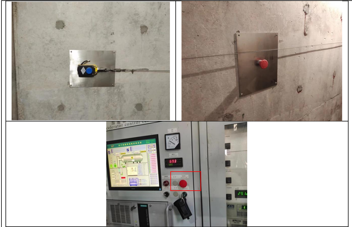
图3-8 本项目急停按钮及拉线开关装置
