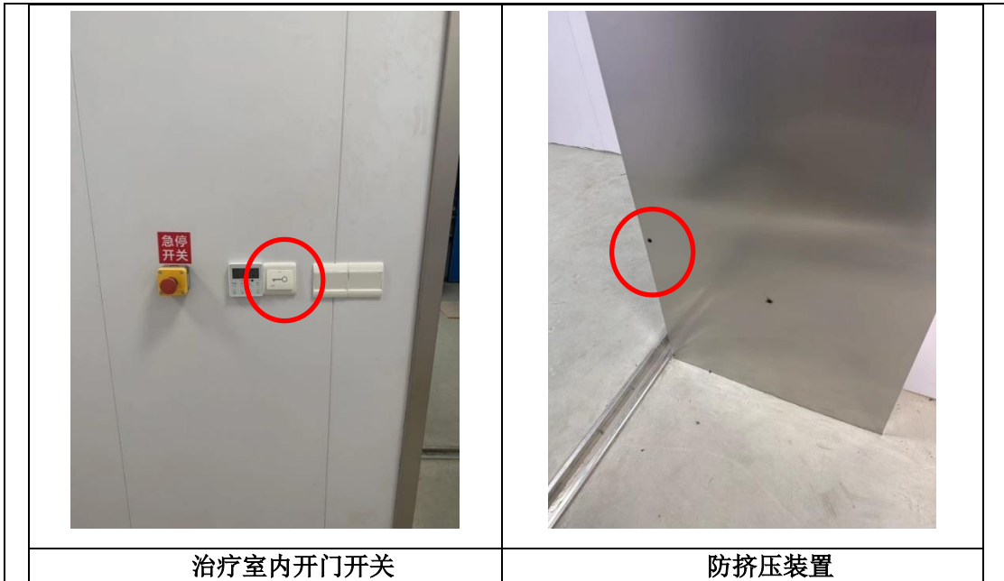
图3-7 本项目陀螺刀机房内开门开关及防挤压装置
