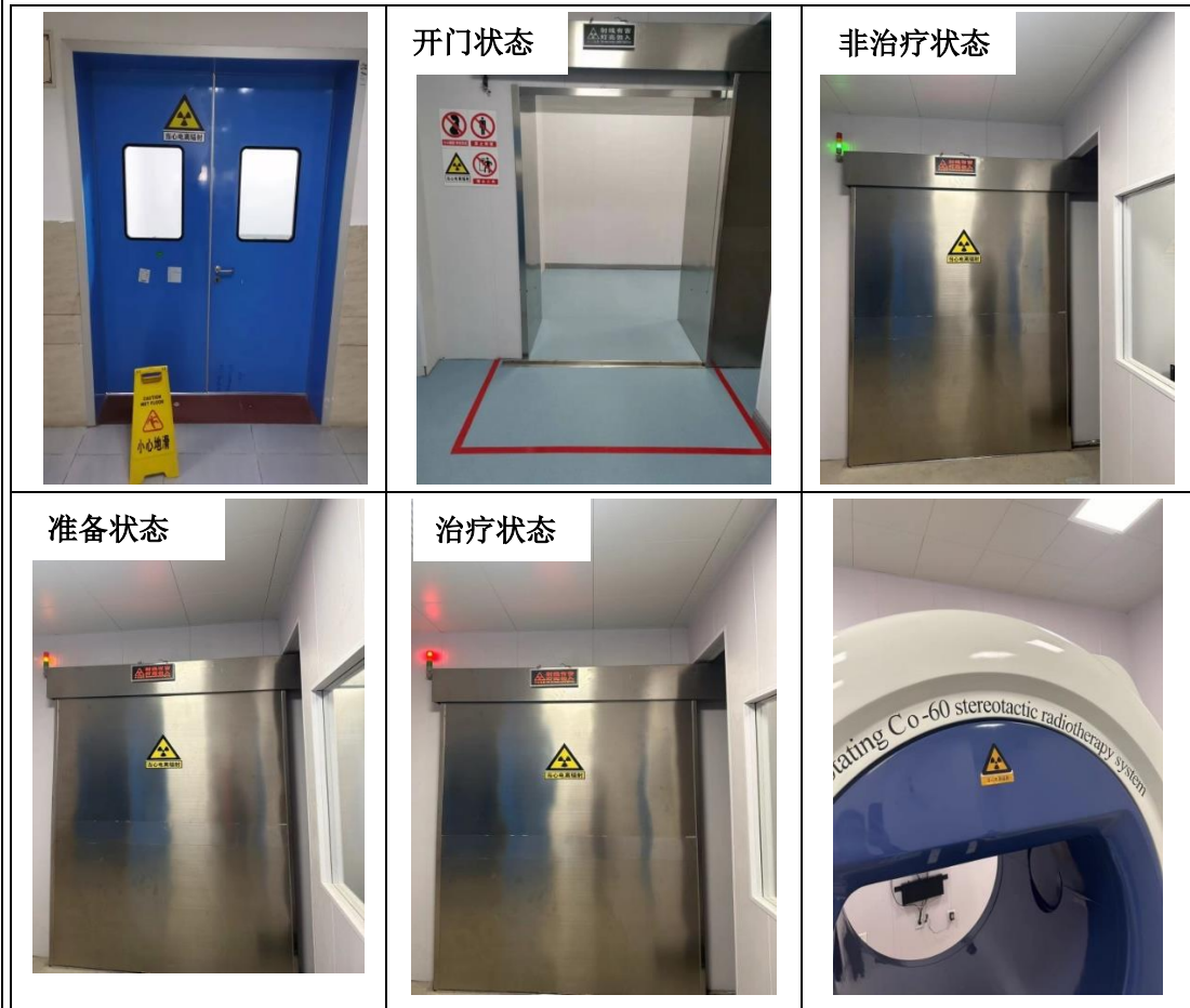
图3-6 本项目陀螺刀机房工作状态指示灯和电离辐射警告标志
