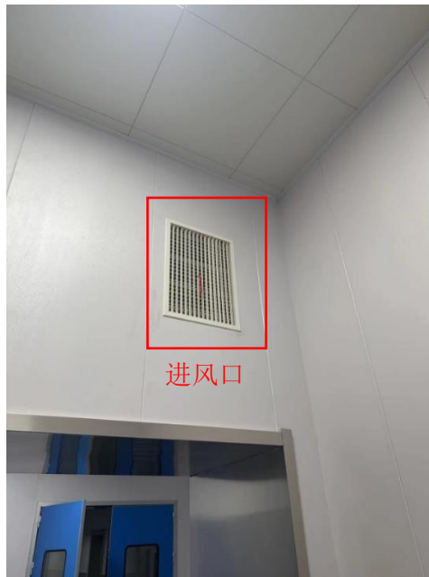
图3-4本项目陀螺刀治疗室进风口位置及剖面示意图及现场图
