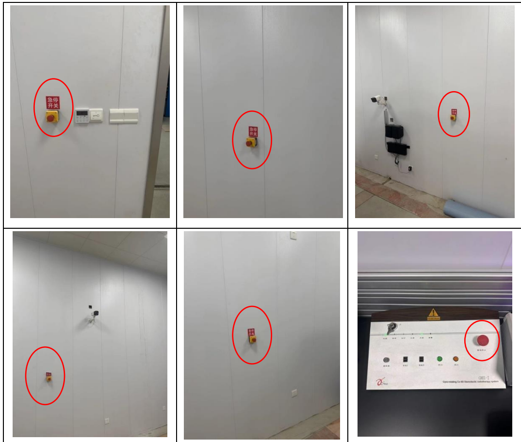
图3-11本项目陀螺刀机房急停按钮现场验证照片
