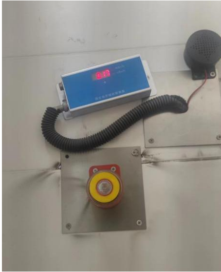
5#机房辐照室迷道内辐射监测探头
