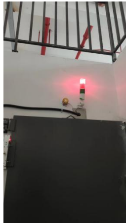
5#机房主机室门口
