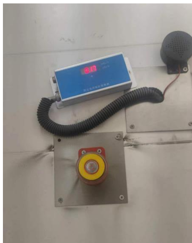
5#加速器机房迷道内报警器
