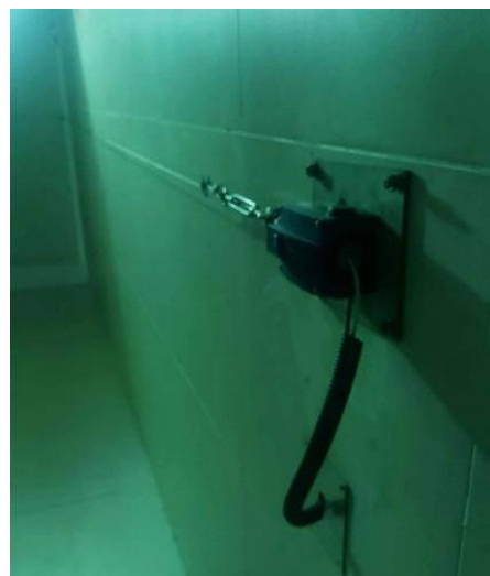
4#机房辐照室拉线开关
