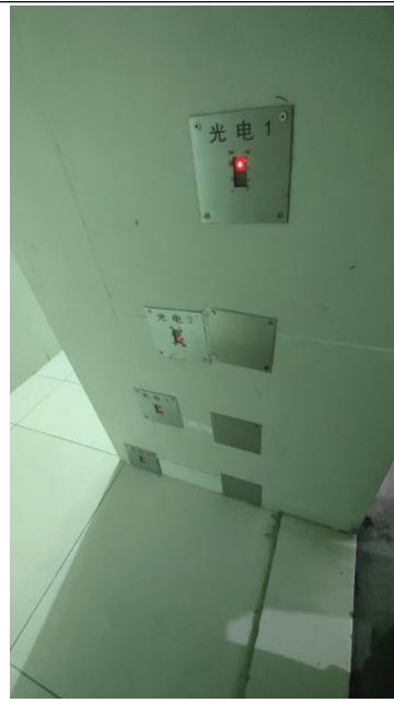
4#机房迷道口光电感应装置
