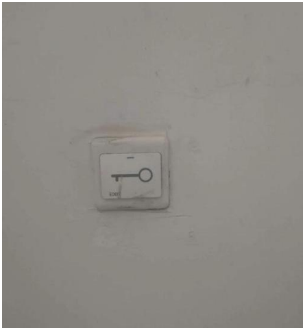
5#机房迷道口防护门内侧紧急开门按钮
