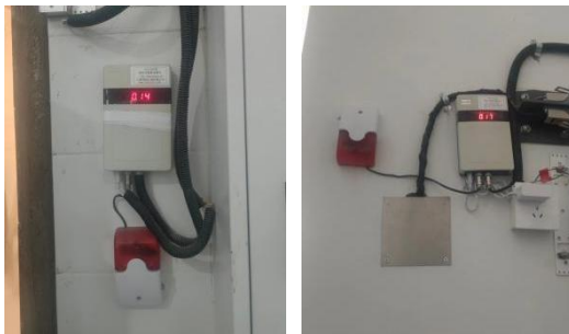
5#机房辐照室、主机室门口剂量显示及报警器
