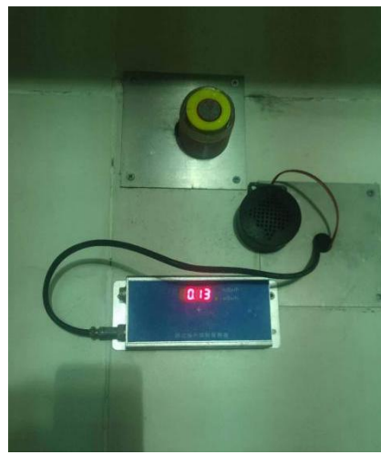
4#加速器机房迷道内报警器
