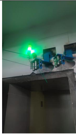
5#机房主机室门口
