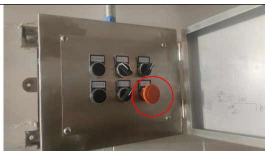
5#机房迷道内束下控制箱内急停按钮
