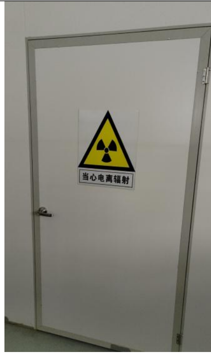
控制室防护门上
