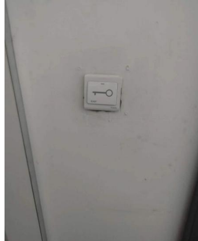
4#机房迷道口防护门内侧紧急开门按钮
