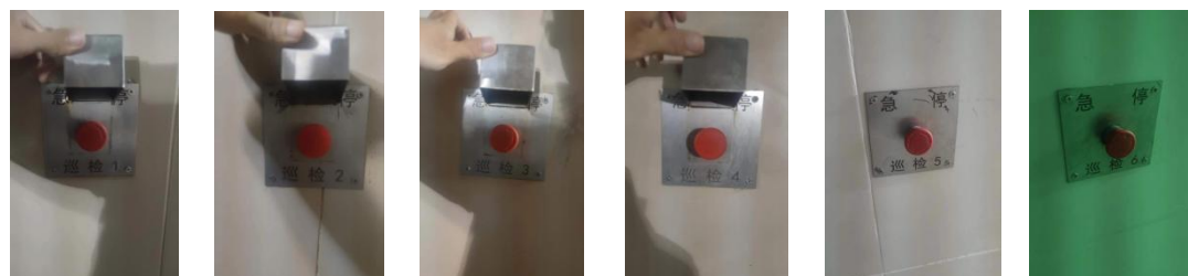
4#加速器机房内巡检/急停按钮
