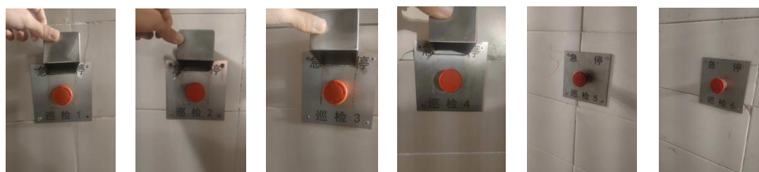
5#加速器机房内巡检/急停按钮
