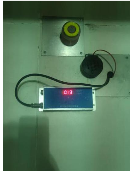
4#机房辐照室迷道内辐射监测探头
