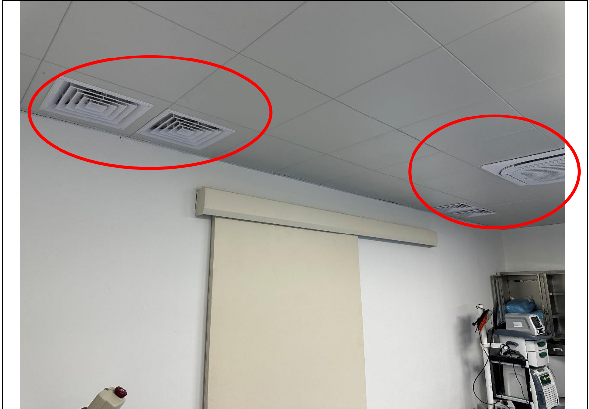
图3-8 手术室内通风装置
