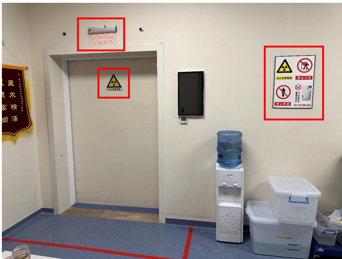
病人入口防护门闭门状态
