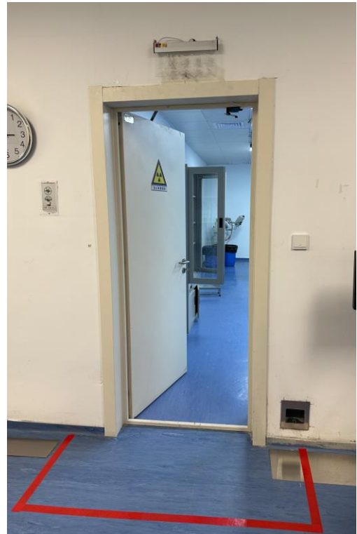
控制室防护门开门状态
