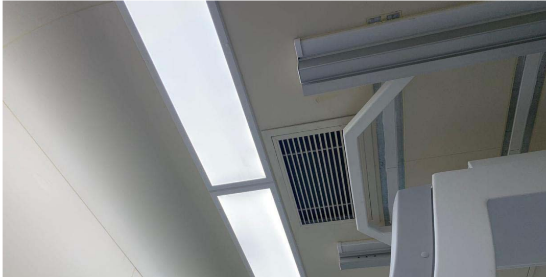
图3-8 机房内通风装置
