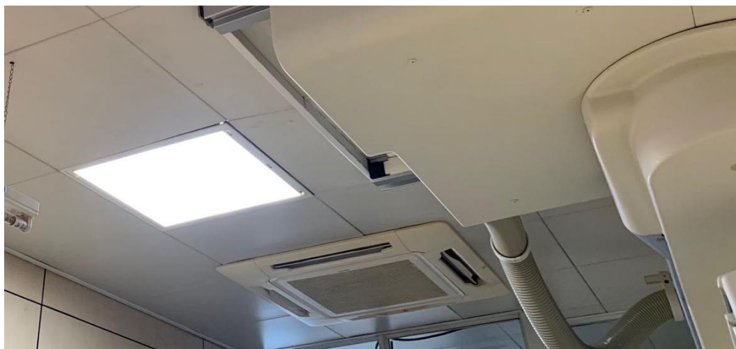
图3-8 机房内通风装置
