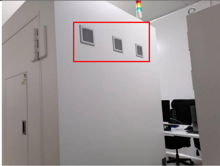
图3-6 本项目工业CT检测装置排风装置
