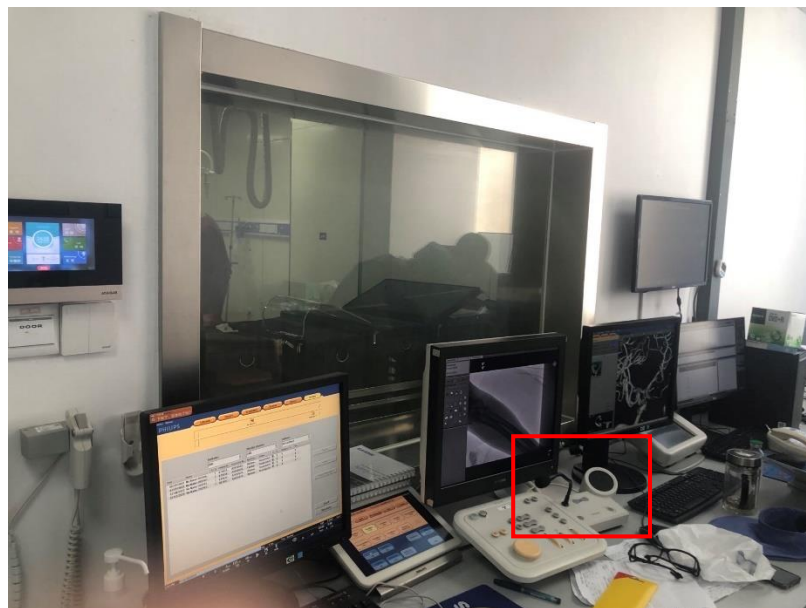
图3-4 本项目DSA机房观察窗及对讲装置
