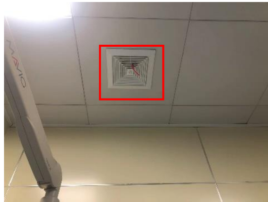
图 3-8 本项目 DSA 机房通风系统
