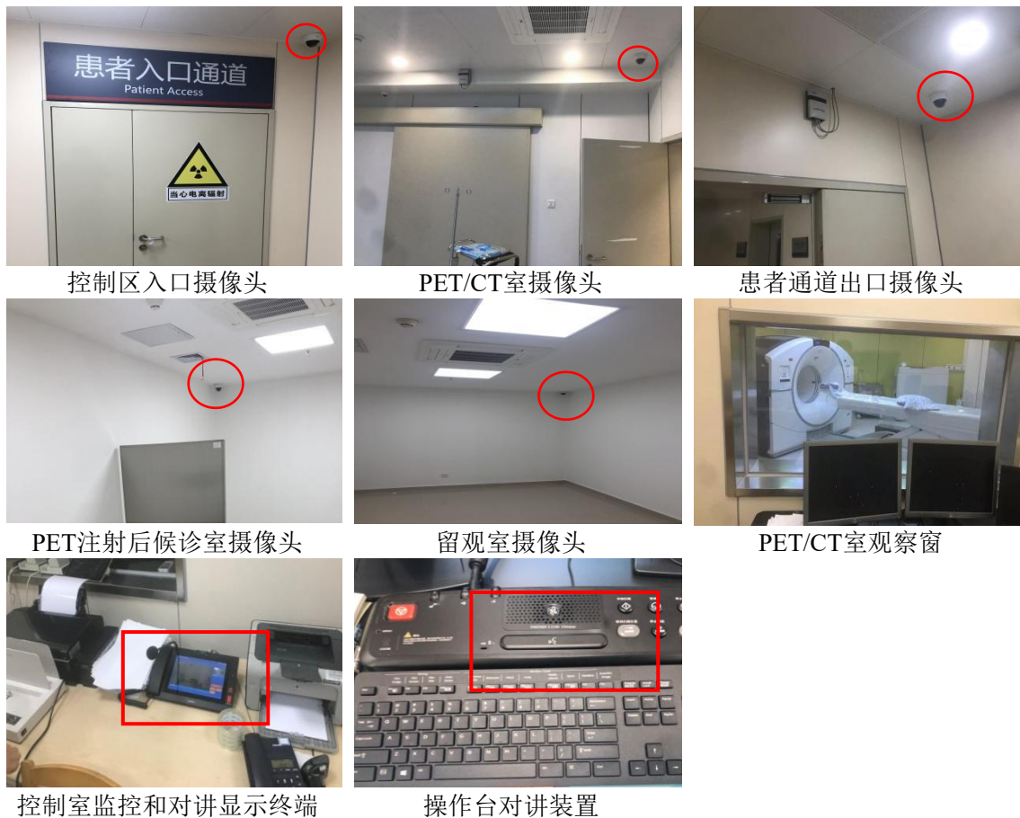
图3-3 本项目核医学工作场所影像监控装置、摄像头及对讲系统
