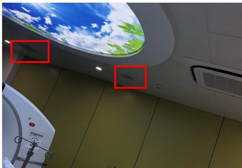
图 3-11 PET/CT 机房内通风装置
