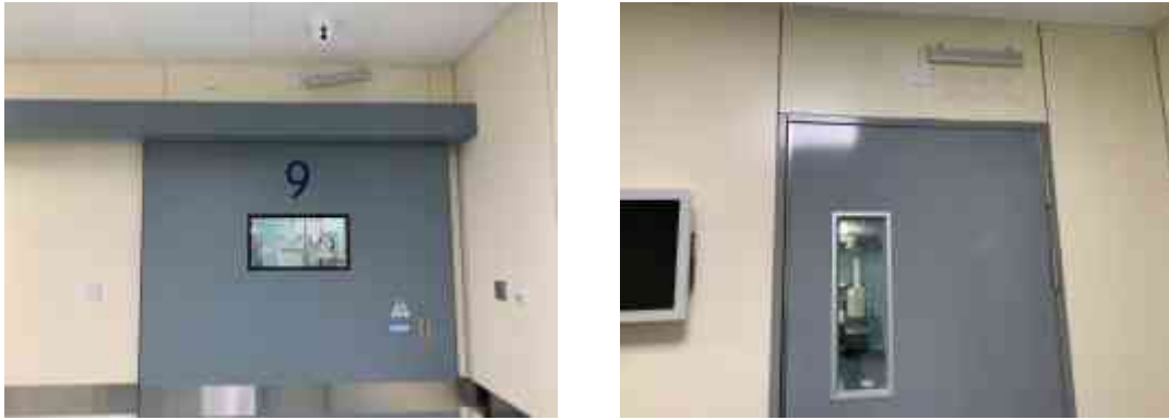
图3-2 工作状态指示灯和电离辐射警告标志
