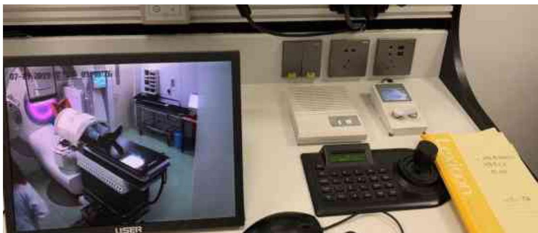
(a) 医用直线加速器机房对讲装置
