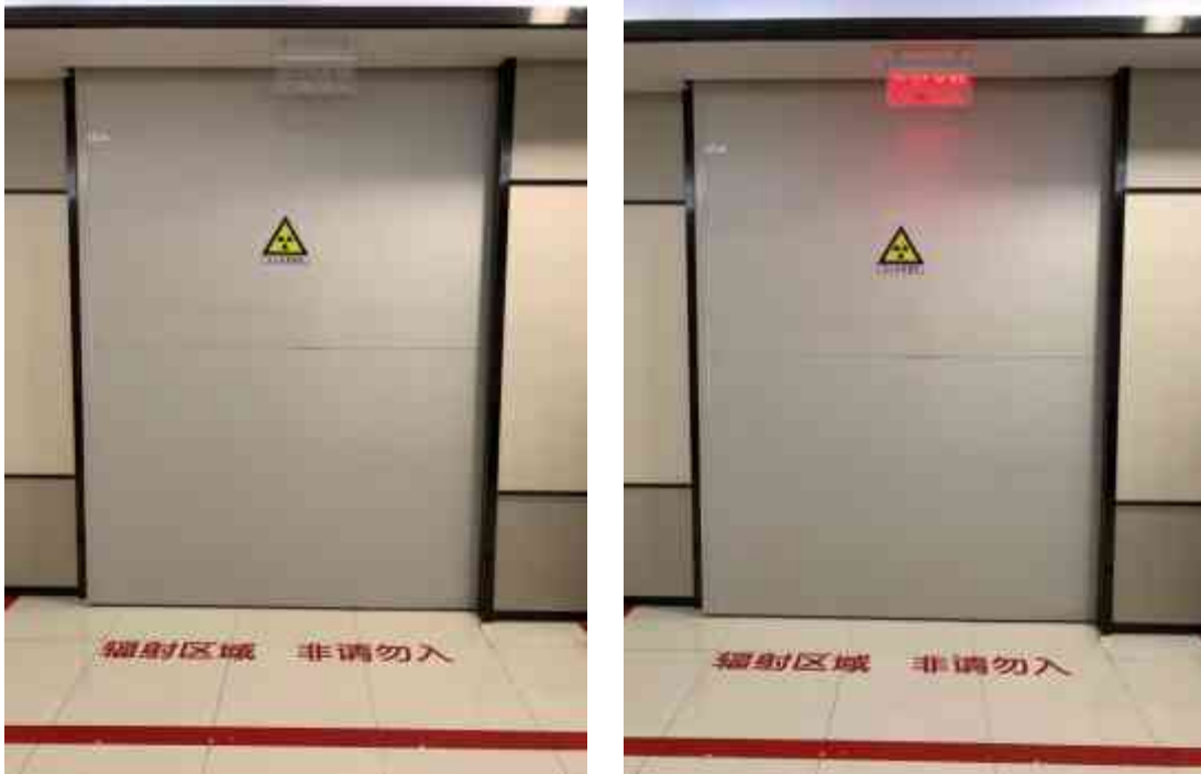
(a) 医用直线加速器机房防护门
