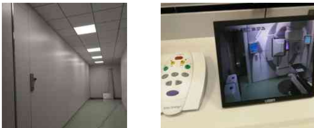
(a) 医用直线加速器机房
