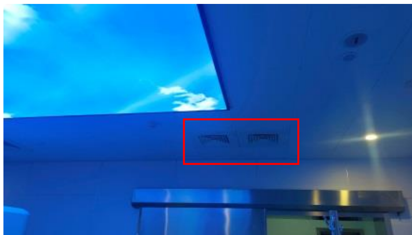
图 3-9 PET/CT 机房内通风装置
