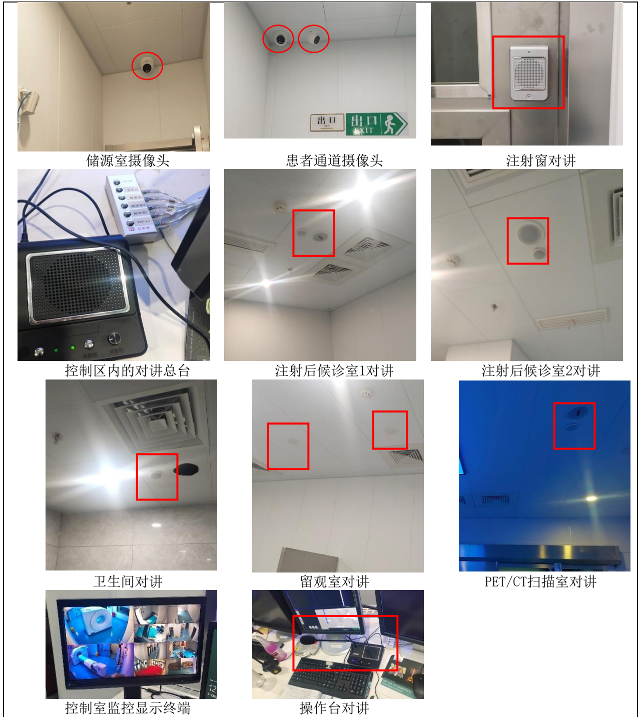
图3-3 本项目核医学工作场所影像监控装置、摄像头及对讲系统
