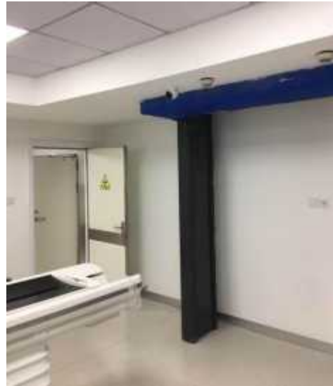
(b) PET/CT机房操作间防护门
