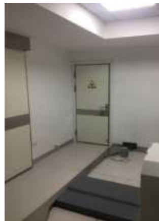
(g) 储源室防护门
