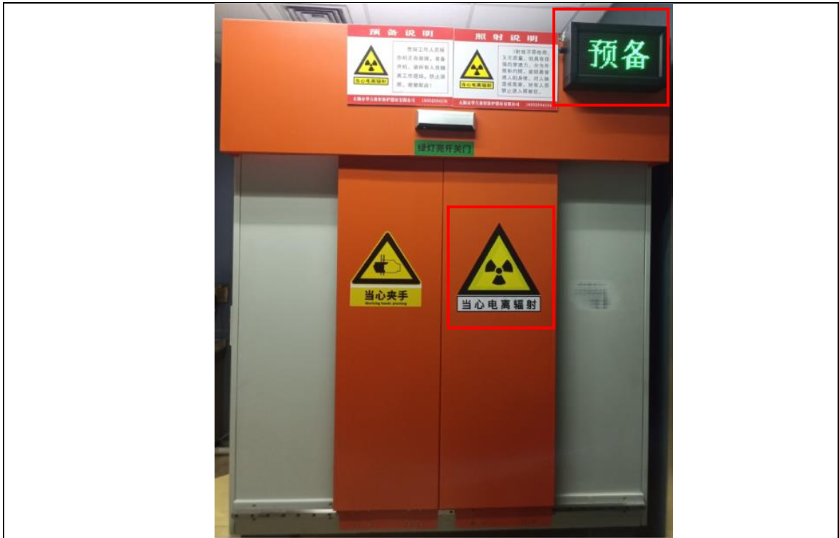
图3-4 固定制式X射线探伤系统工作状态指示灯和电离辐射警告标志
