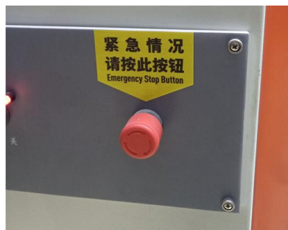
图3-5 探伤铅房设置急停按钮
