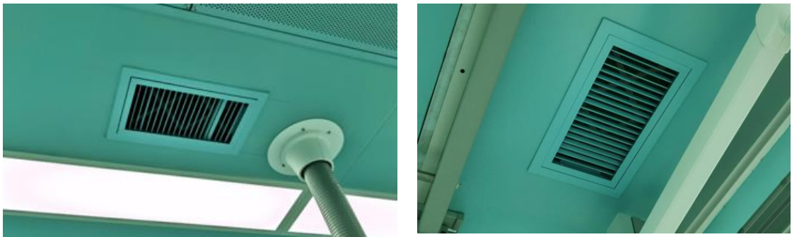
手术室5室排风口
