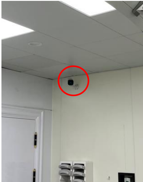
机房内东北角摄像头
