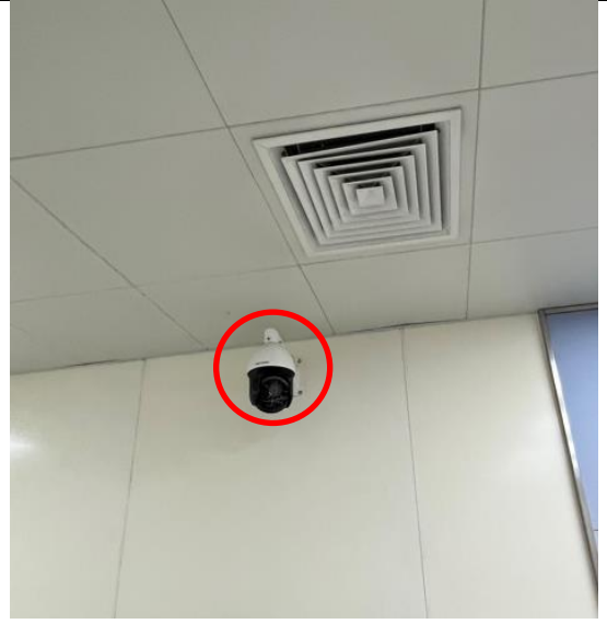
机房内南墙中部摄像头
