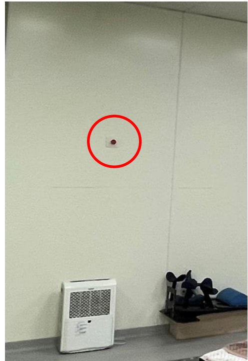
机房内西墙急停按钮
