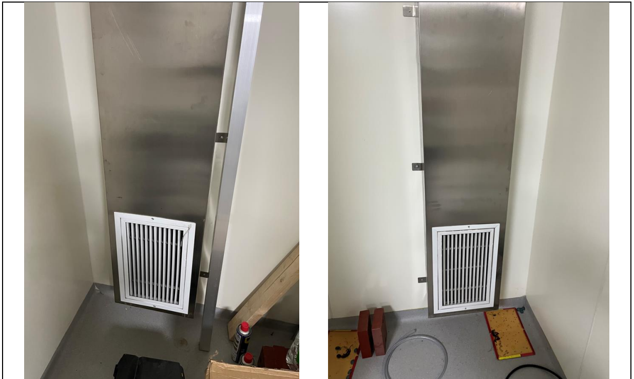
加速器机房内东侧风口
