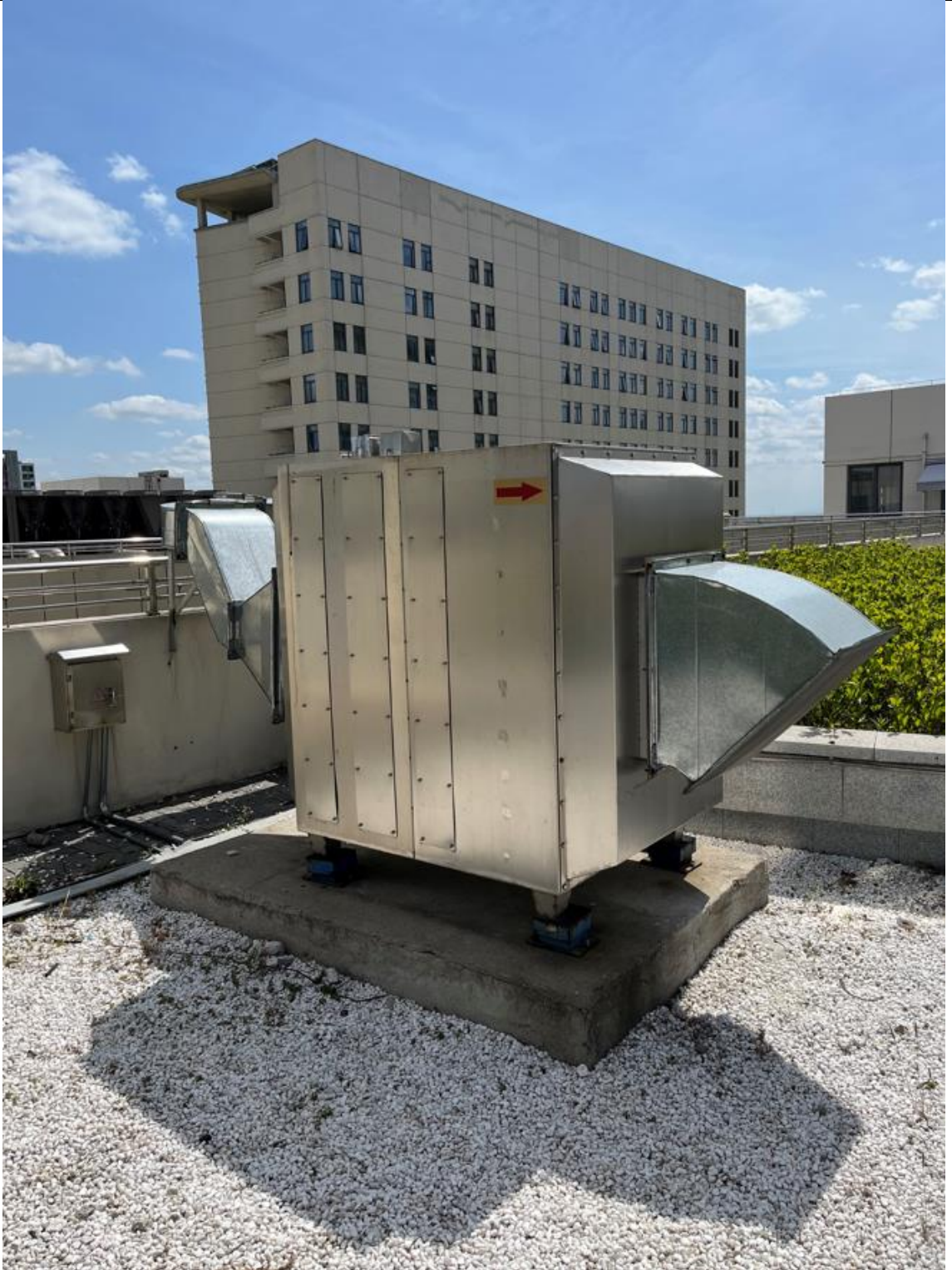
图 3-26 核医学工作场所楼顶外排风口
