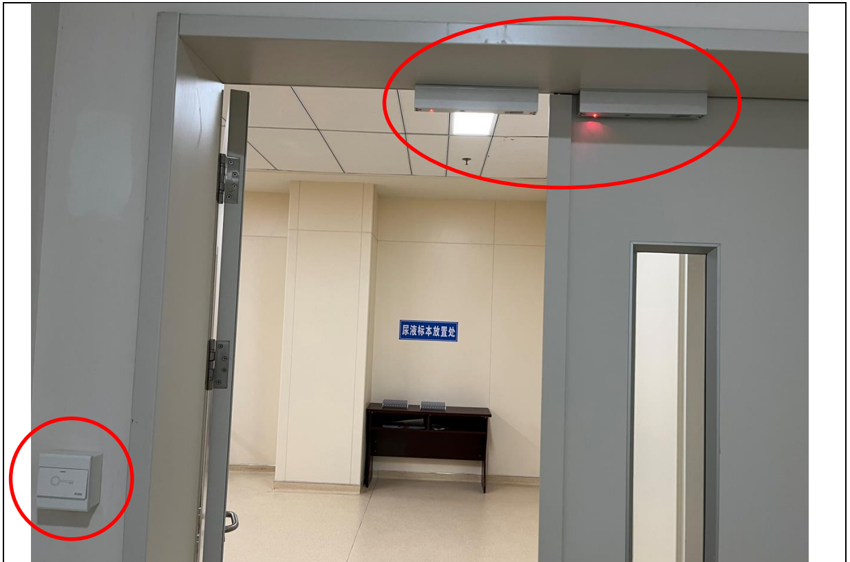
图3-17 内部门禁开门开关及吸门装置
