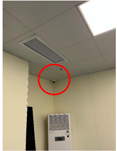
机房内东南角摄像头
