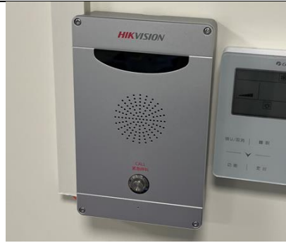
机房内语音对讲装置
