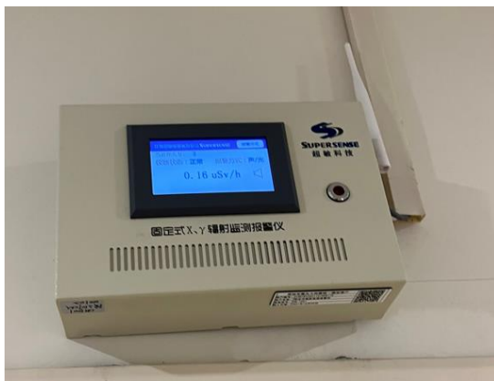
医生通道内辐射监测仪
