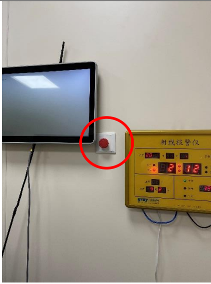
控制室内急停按钮
