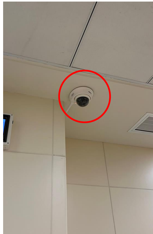
核医学工作场所入口处摄像头
