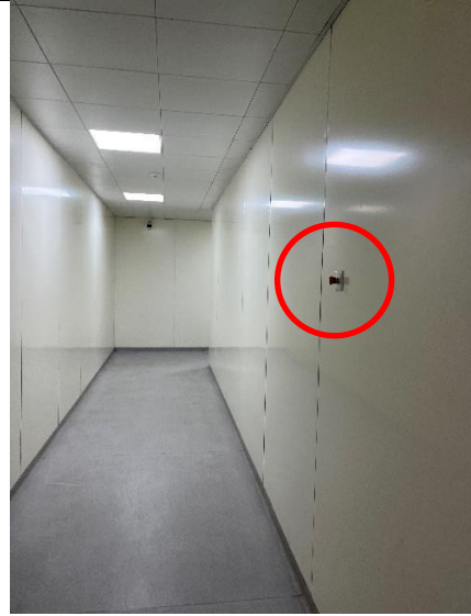
机房内迷道墙壁急停按钮
