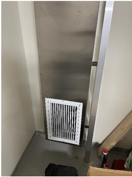
机房内东北角通风口
