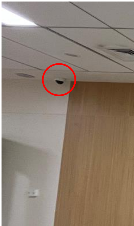
核医学工作场所入口处摄像头
