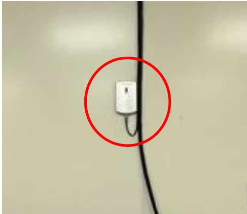
机房内剂量探头
