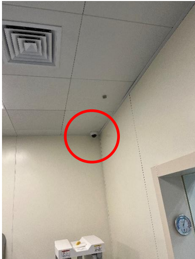
机房内西北角摄像头
