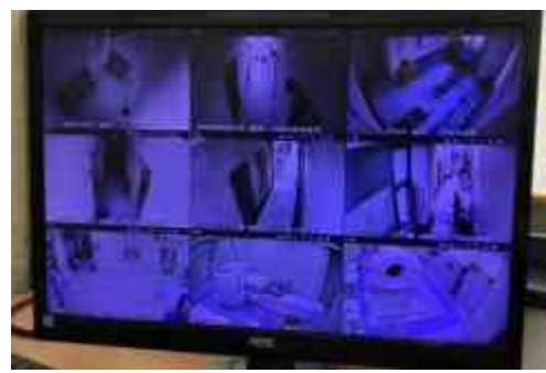
(b) 控制室内监控显示终端
