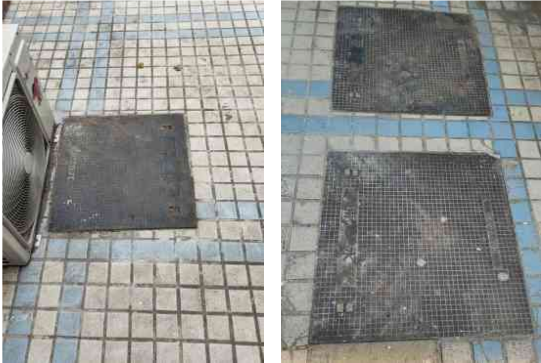
图 3-12 放射性废水衰变池
