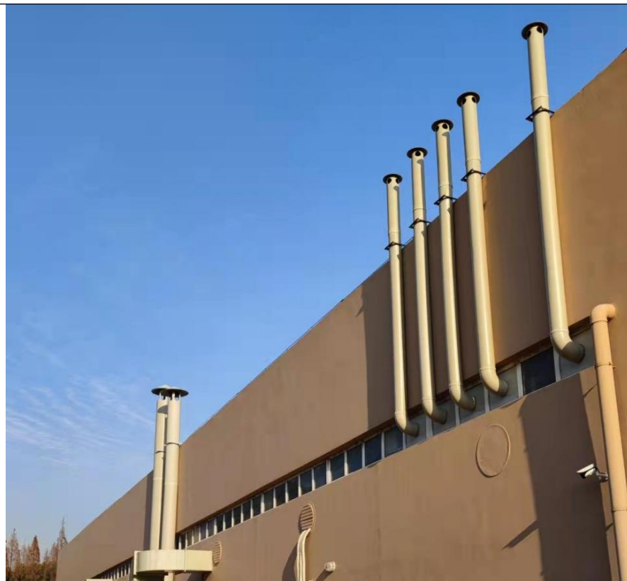
图3-13 乙级非密封源工作场所内通风设施及楼顶排风设施
