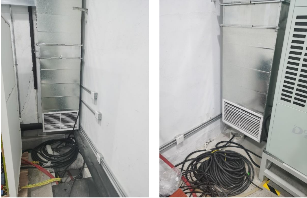
图 4-32 5#医用直线加速器测试机房内排风口
