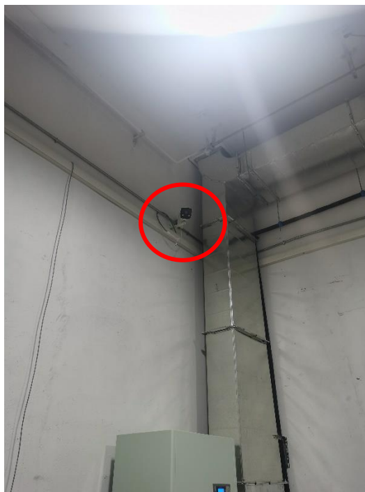
测试机房内监控探头
