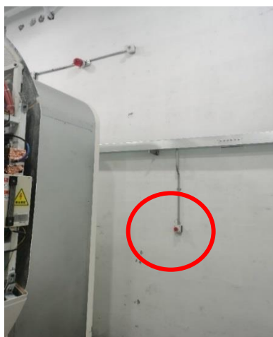
测试机房内部急停开关
