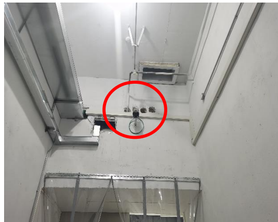
测试机房内监控探头
