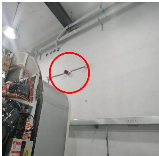
1#医用直线加速器测试机房
