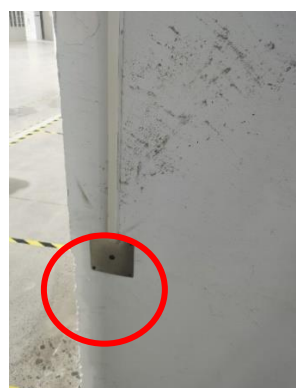
7#加速器测试机房防人误入装置
