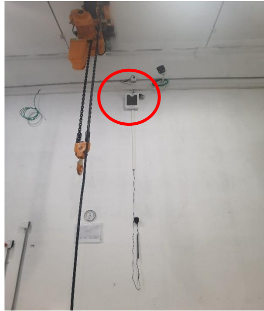
测试机房内对讲装置
