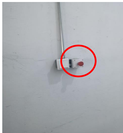
入口处急停开关
