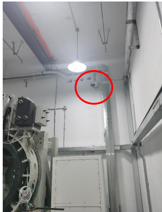
测试机房内监控探头
