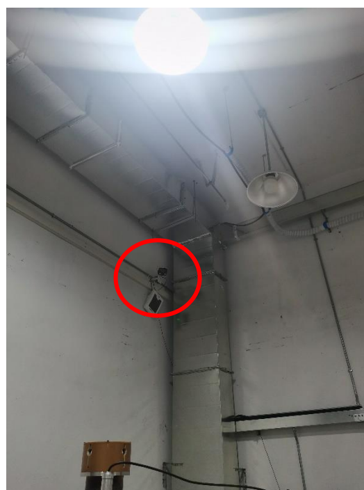
测试机房内监控探头
