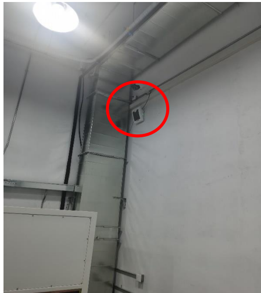
测试机房内对讲装置
