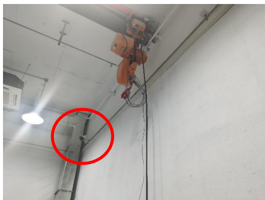
测试机房内监控探头
