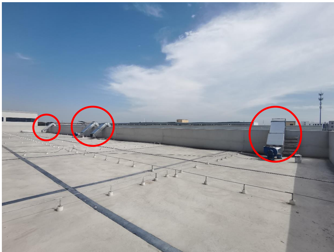
图 4-34 医用直线加速器测试机房外排风口
