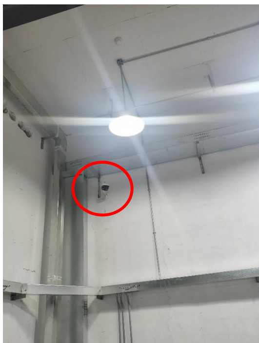
测试机房内监控探头
