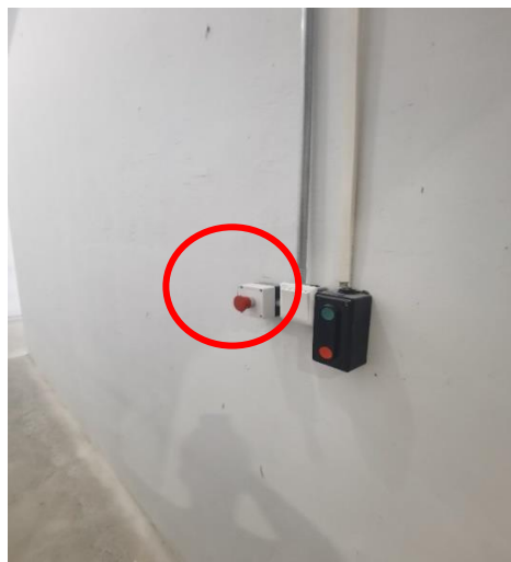
入口处急停开关
