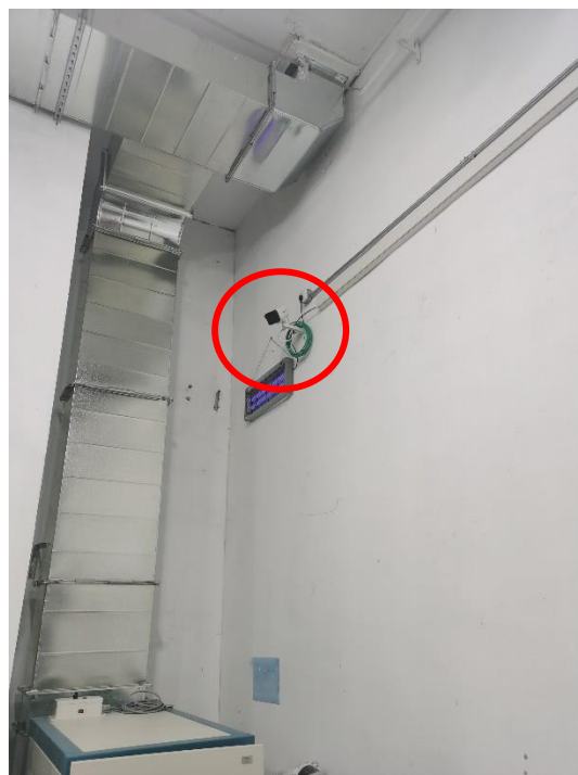
测试机房内监控探头
