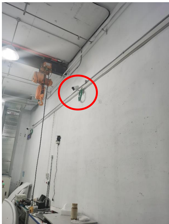
测试机房内监控探头
