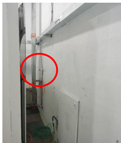
测试机房内部急停开关
