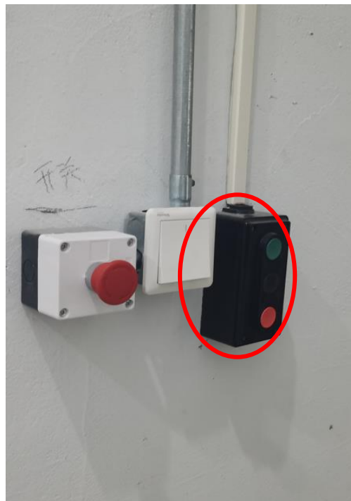
7#医用直线加速器测试机房内防护门开关
