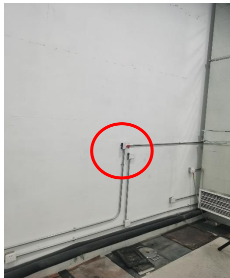
测试机房内部急停开关
