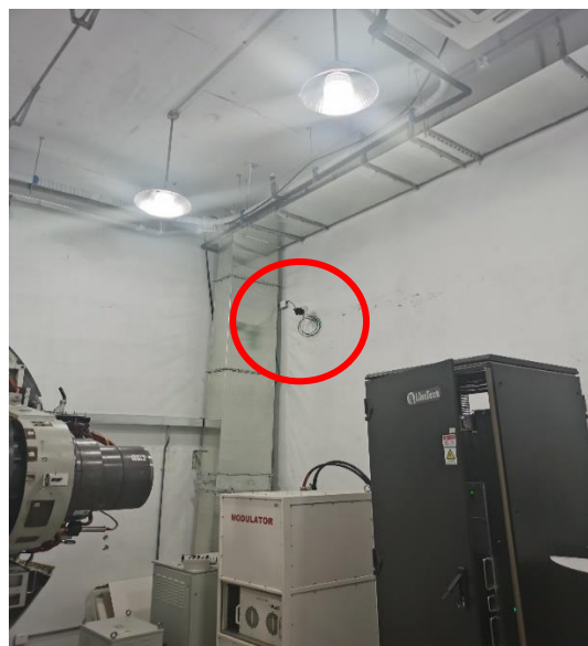
测试机房内监控探头
