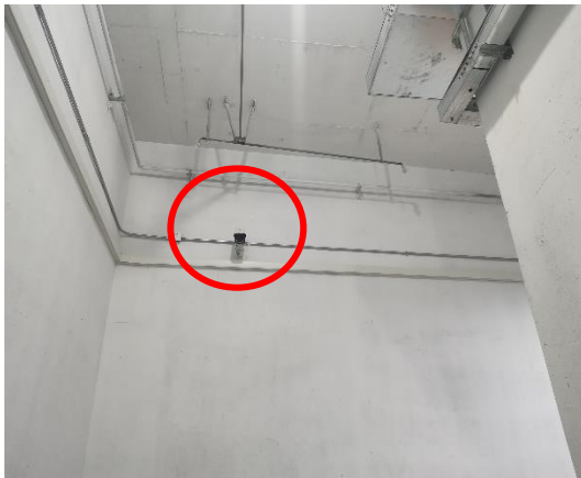
测试机房内监控探头
