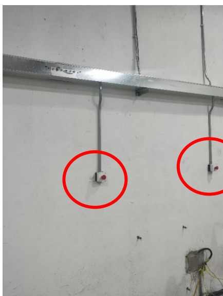
测试机房内部急停开关
