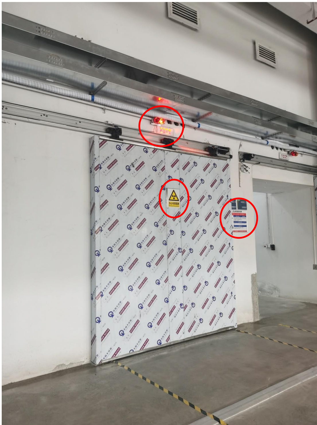
图 4-4 5#医用直线加速器测试机房工作状态指示灯、电离辐射警告标志和职业病危害告知卡
