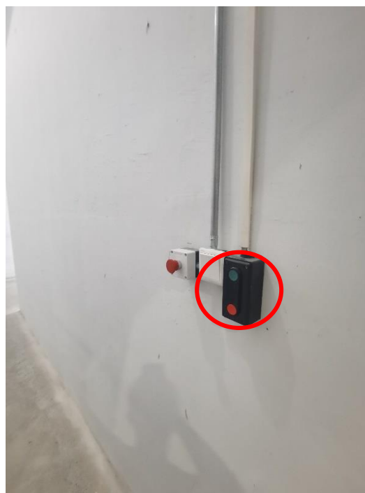
3#医用直线加速器测试机房内防护门开关
