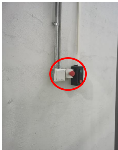
入口处急停开关
