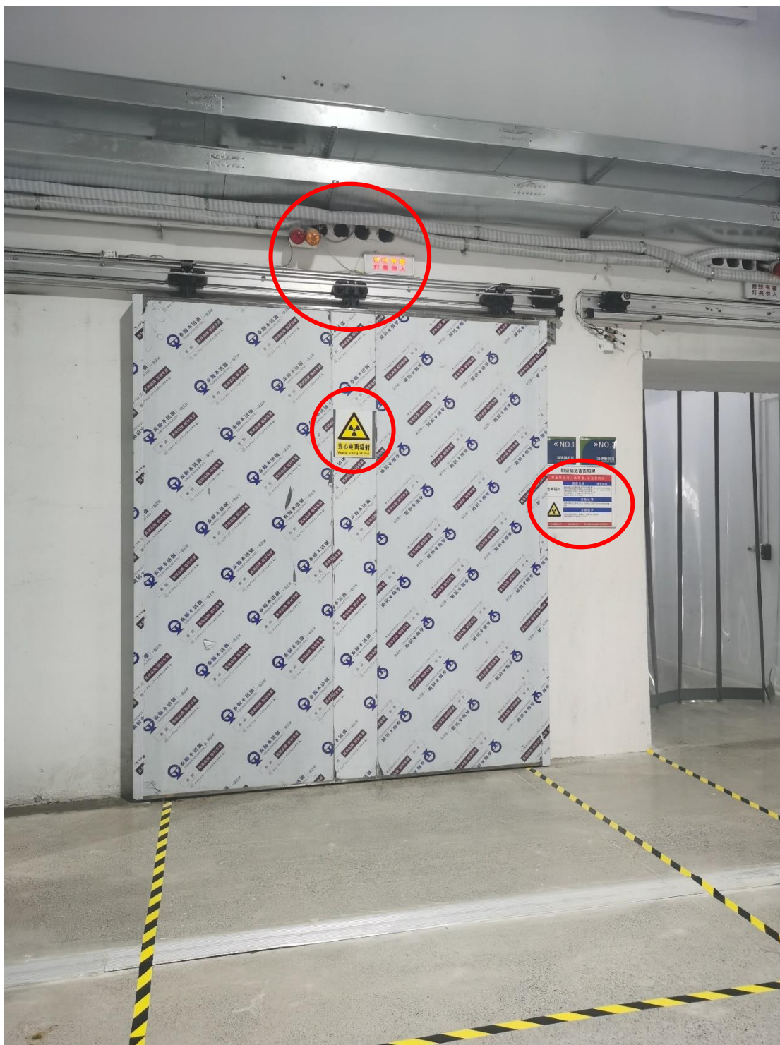
图 4-2 1#医用直线加速器测试机房工作状态指示灯、电离辐射警告标志和职业病危害告知卡
