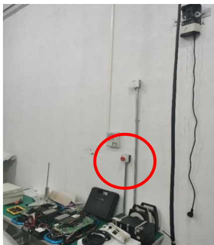
测试机房内部急停开关
