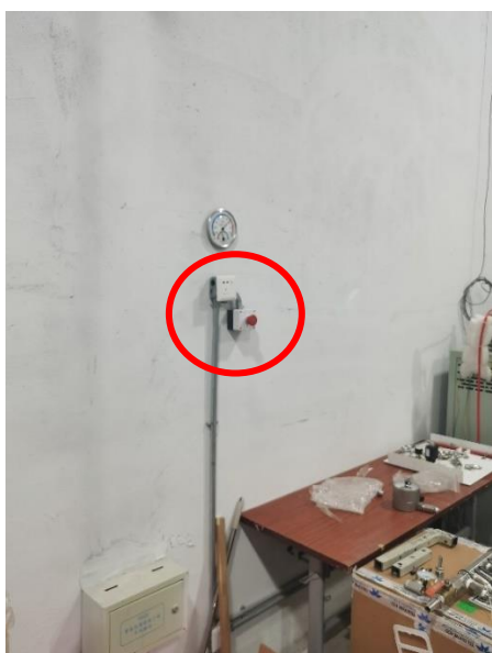
测试机房内部急停开关
