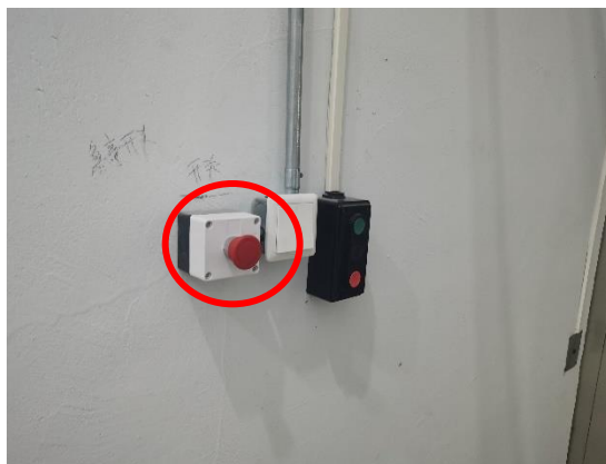
入口处急停开关
