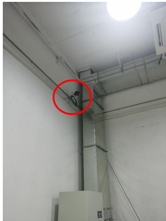
测试机房内监控探头
