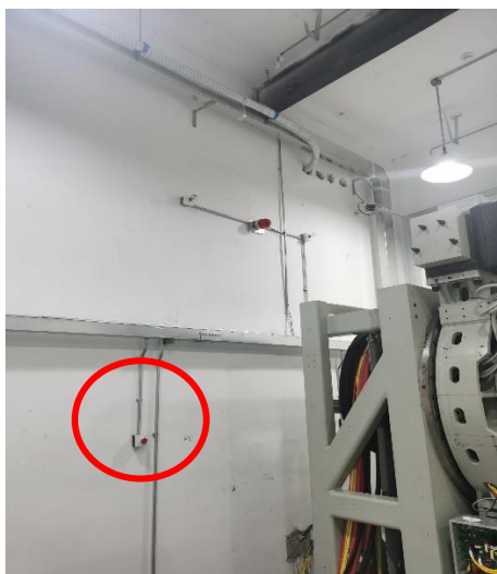
测试机房内部急停开关
