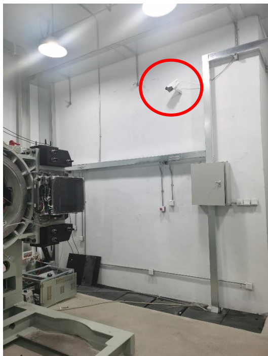
测试机房内监控探头
