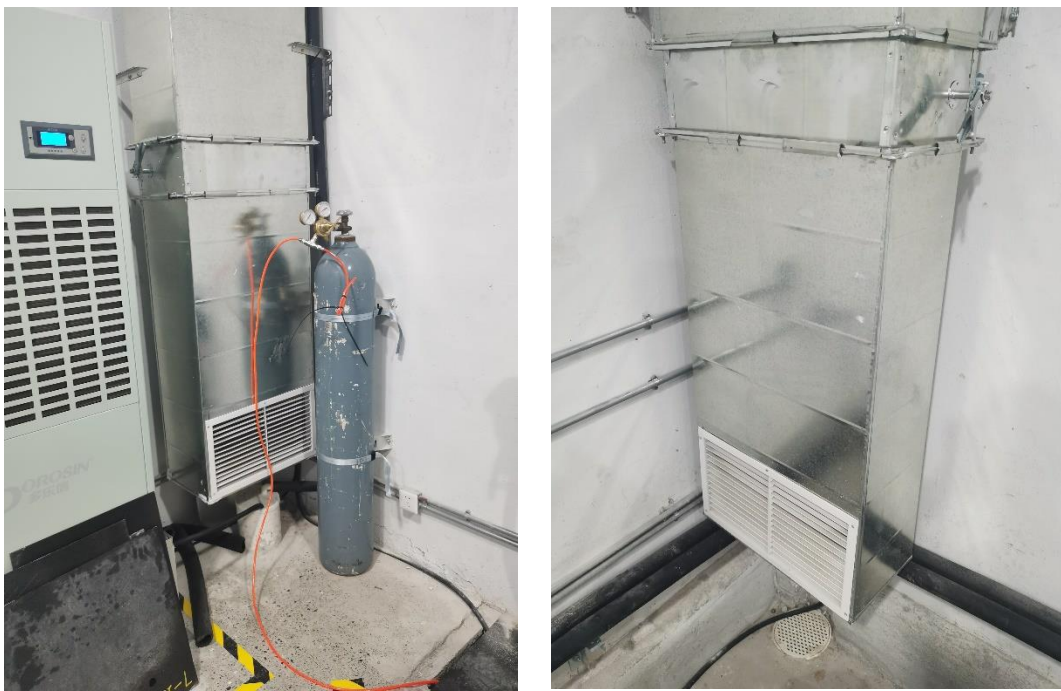
图 4-33 7#医用直线加速器测试机房内排风口
