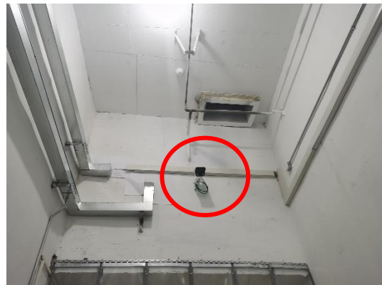
测试机房内监控探头
