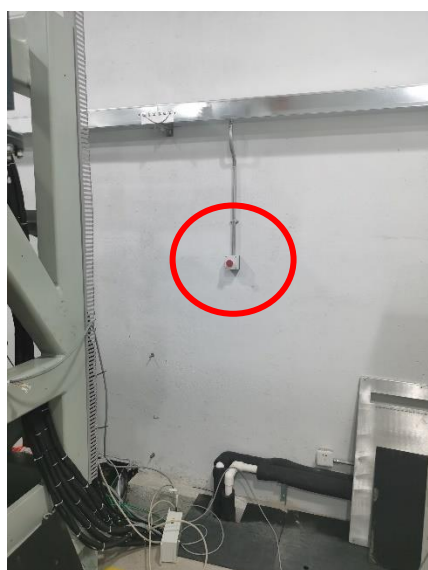
测试机房内部急停开关
