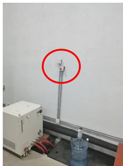
测试机房内部急停开关
