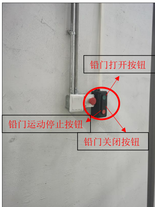
1#医用直线加速器测试机房内防护门开关
