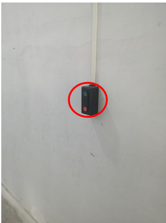
5#医用直线加速器测试机房内防护门开关
