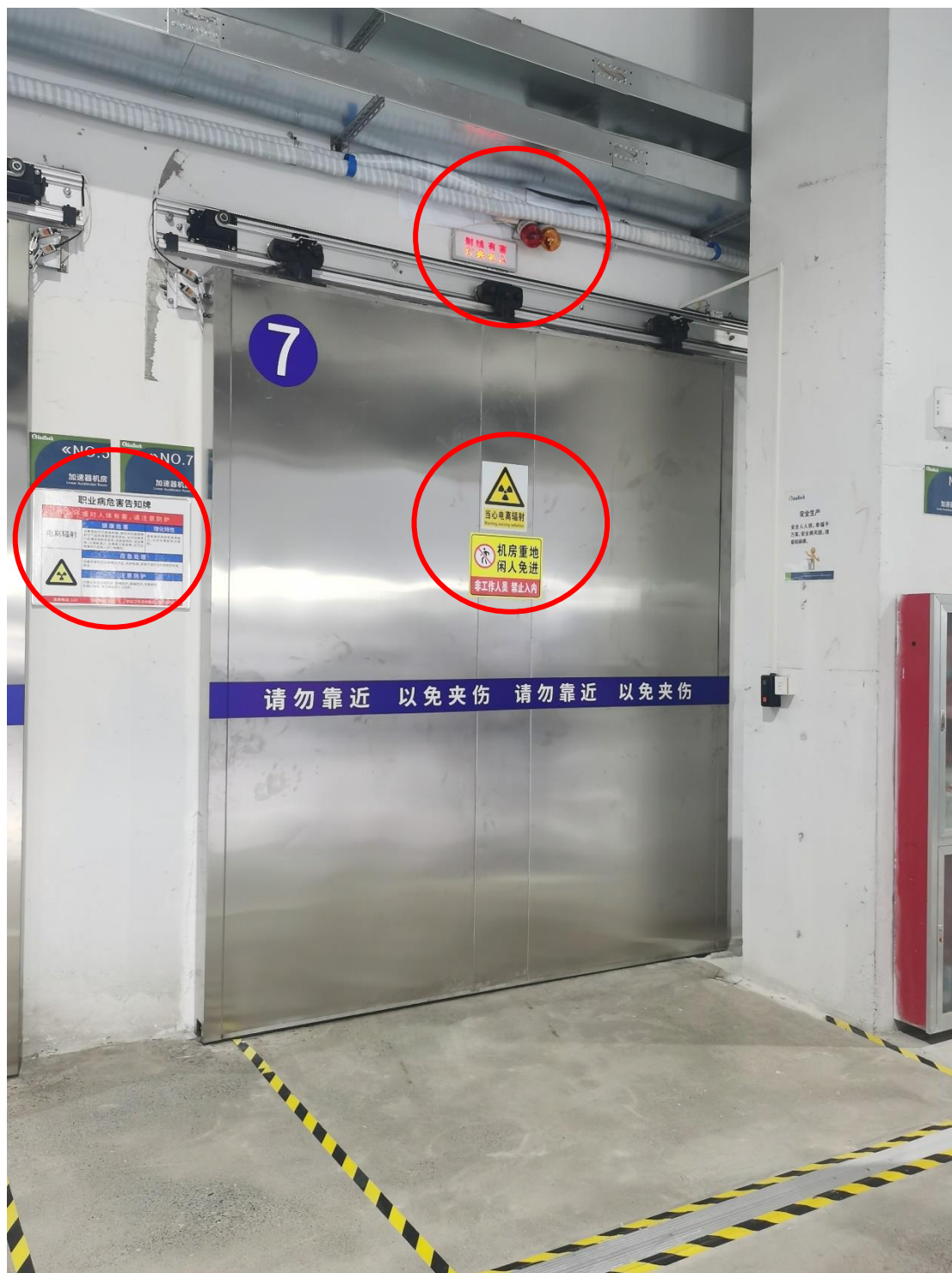
图 4-5 7#医用直线加速器测试机房工作状态指示灯、电离辐射警告标志和职业病危害告知卡
