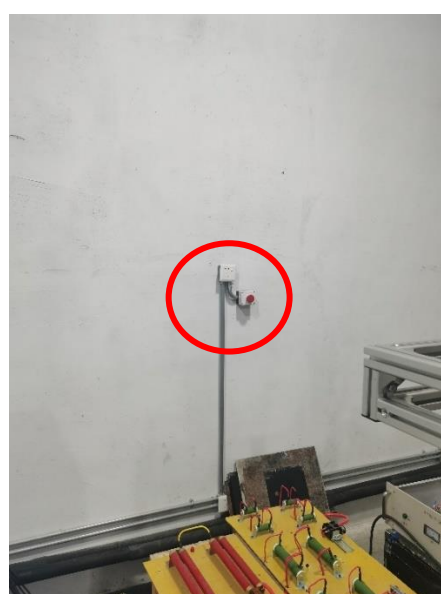
测试机房内部急停开关
