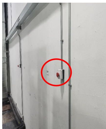
测试机房内部急停开关
