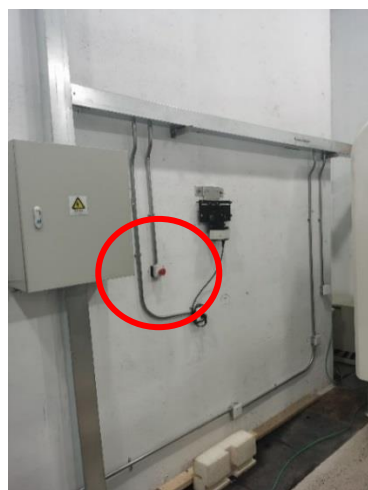
测试机房内部急停开关
