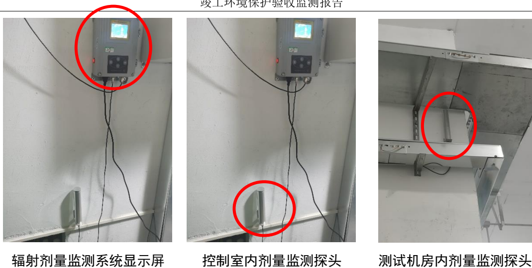
图 4-18 5#医用直线加速器测试机房固定式辐射剂量监测系统
