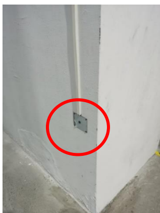
1#加速器测试机房防人误入装置
