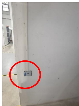
3#加速器测试机房防人误入装置
