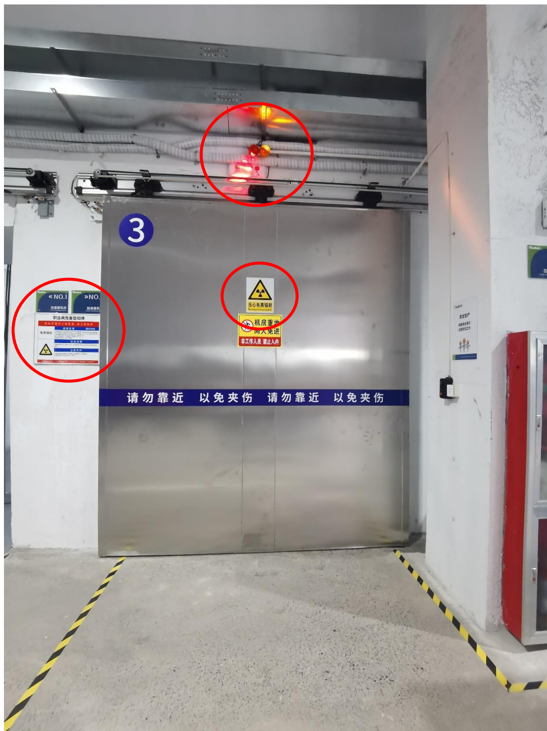
图 4-3 3#医用直线加速器测试机房工作状态指示灯、电离辐射警告标志和职业病危害告知卡
