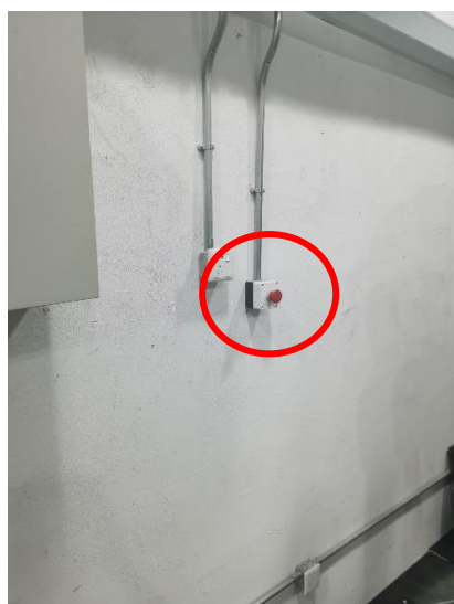
测试机房内部急停开关
