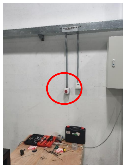
测试机房内部急停开关
