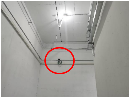
测试机房内监控探头
