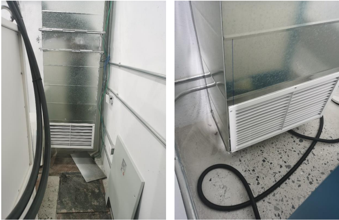
图 4-30 1#医用直线加速器测试机房内排风口
