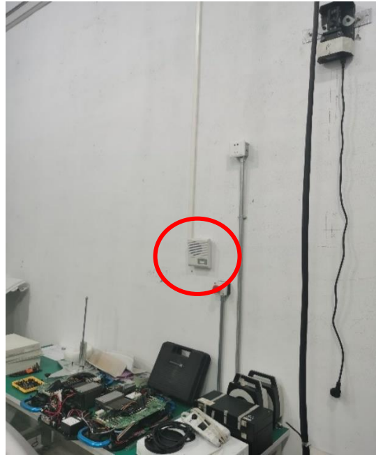
测试机房内对讲装置
