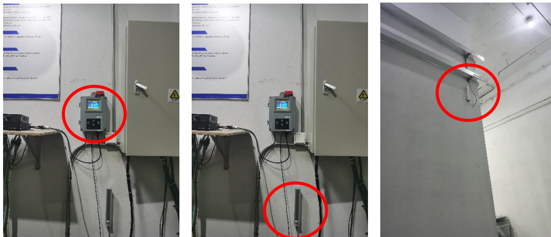
辐射剂量监测系统显示屏
