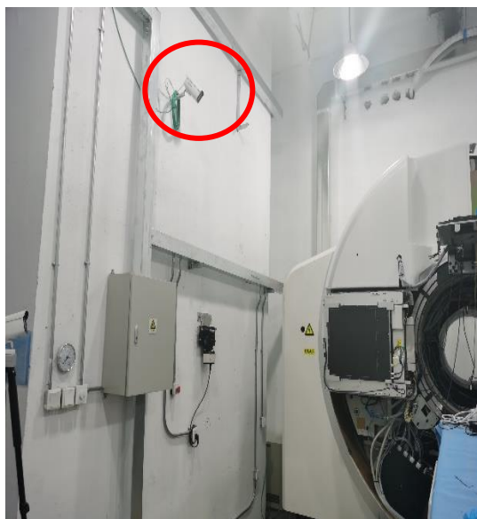
测试机房内监控探头
