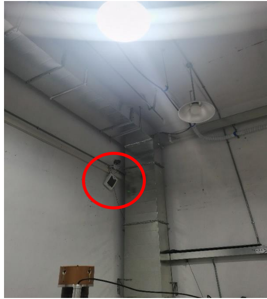
测试机房内对讲装置
