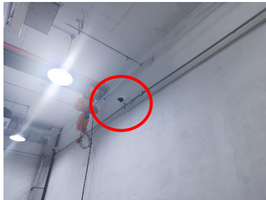
测试机房内监控探头
