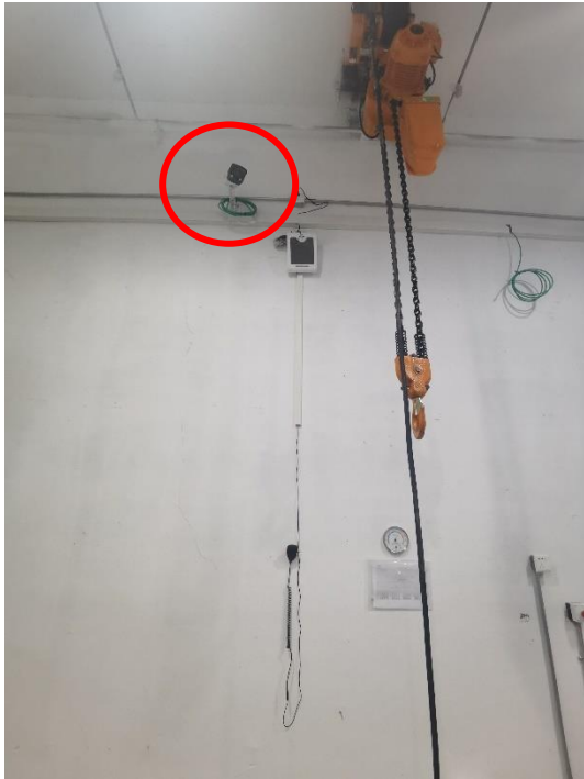
测试机房内监控探头
