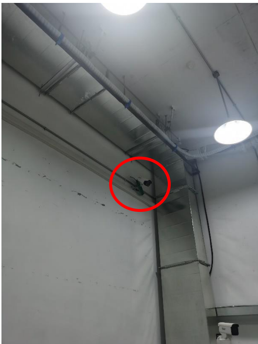
测试机房内监控探头
