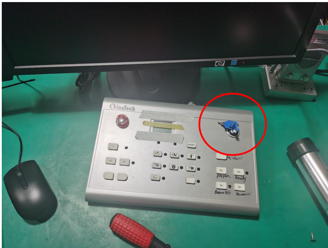
图 4-9 5#医用直线加速器测试机房控制台上钥匙开关
