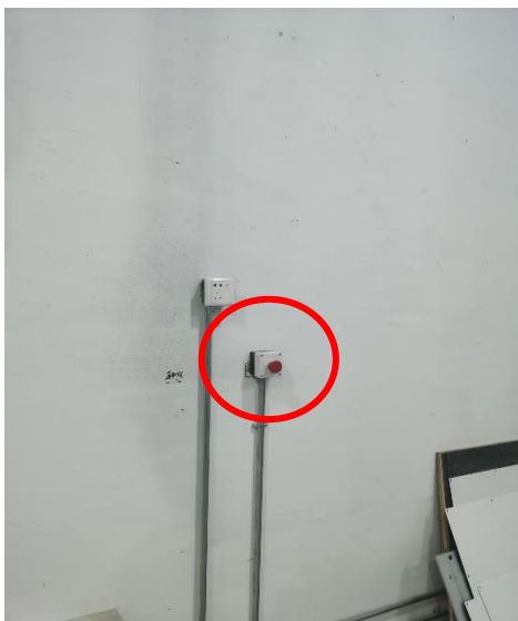
测试机房内部急停开关
