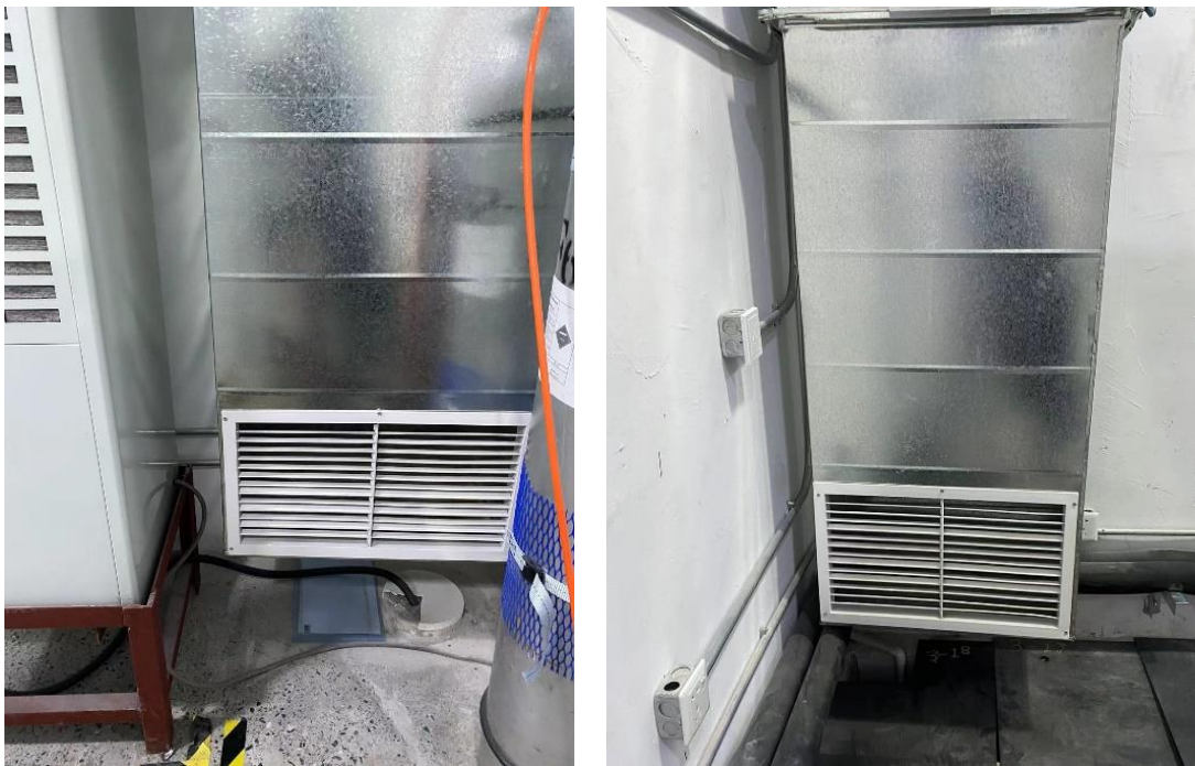
图 4-31 3#医用直线加速器测试机房内排风口
