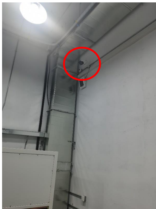
测试机房内监控探头
