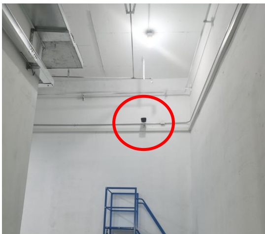
测试机房内监控探头
