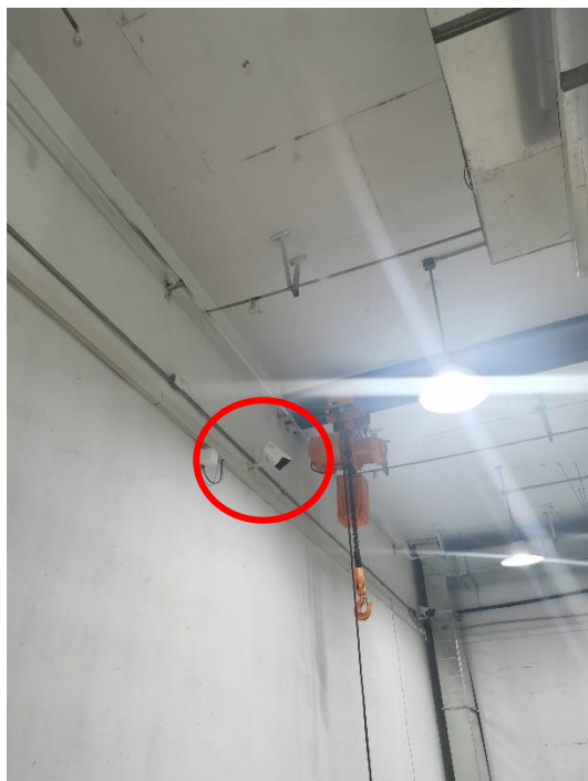
测试机房内监控探头
