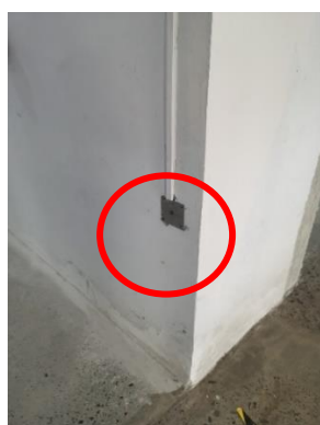
5#加速器测试机房防人误入装置
