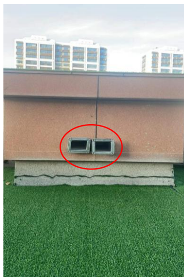
图 4-13 通风管道外排口
