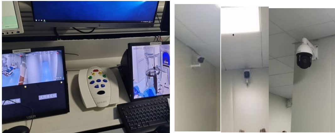
(a) 医用直线加速器1号机房
