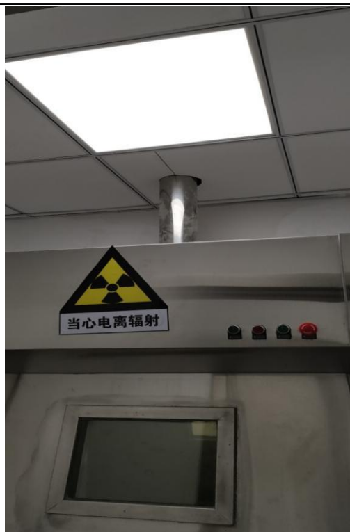
(g) 通风橱排风管道
