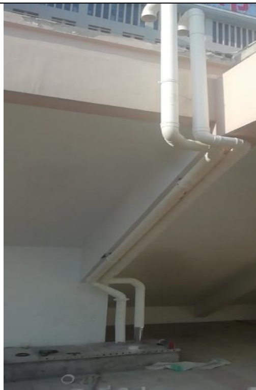
(h) 楼顶排风管道
