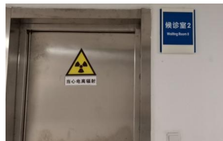
(f) 候诊室2防护门
