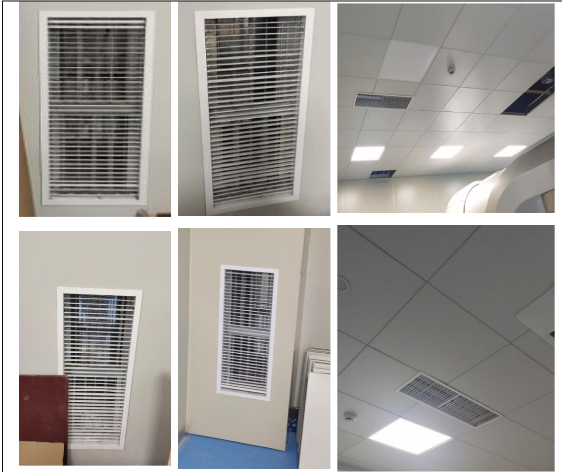
图 3-12 医用直线加速器机房内通风装置
