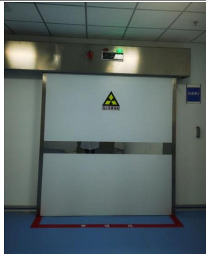
(b) 医用直线加速器2号机房防护门
