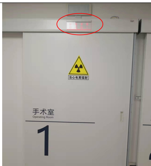
1号手术室防护大门关闭状态
