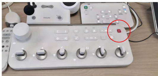
1号手术室操作间控制台上急停按钮
