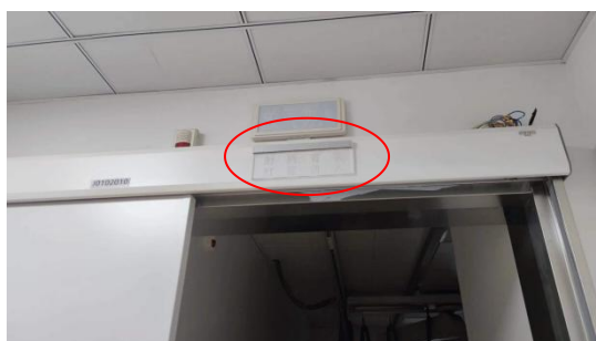
2号手术室防护大门开启状态
