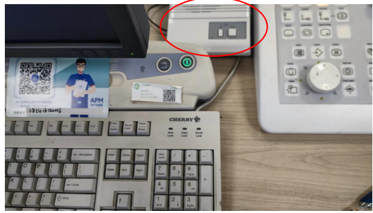
2号手术室操作台语音对讲装置
