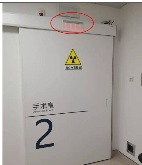
2号手术室防护大门关闭状态
