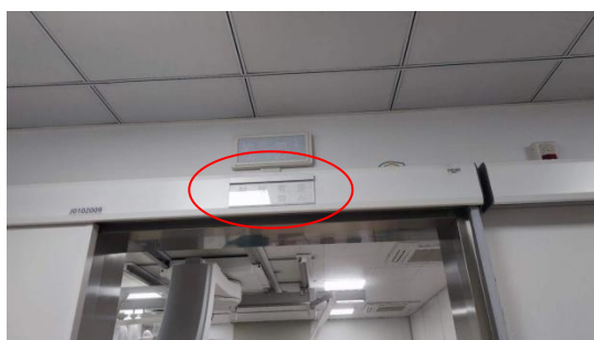
1号手术室防护大门开启状态
