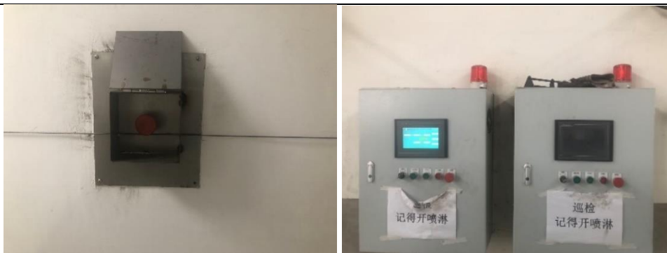
图3-6本项目巡检按钮和巡检装置
