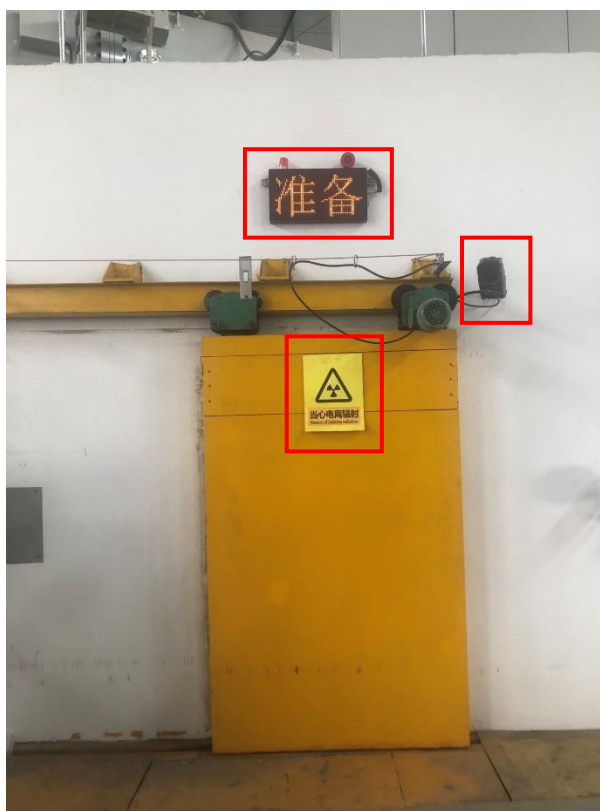
图3-5本项目工业电子加速器机房工作状态指示灯、电离辐射警告标志及音响警示装置
