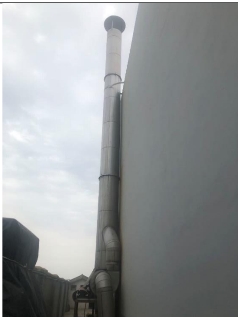
图 3-14 本项目室外通风管道
