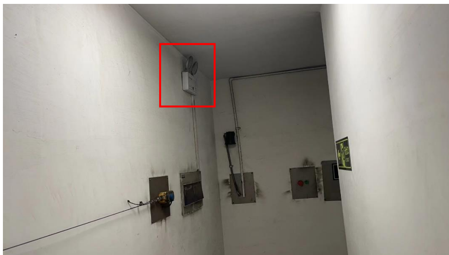
图3-3 本项目机房内应急照明灯
