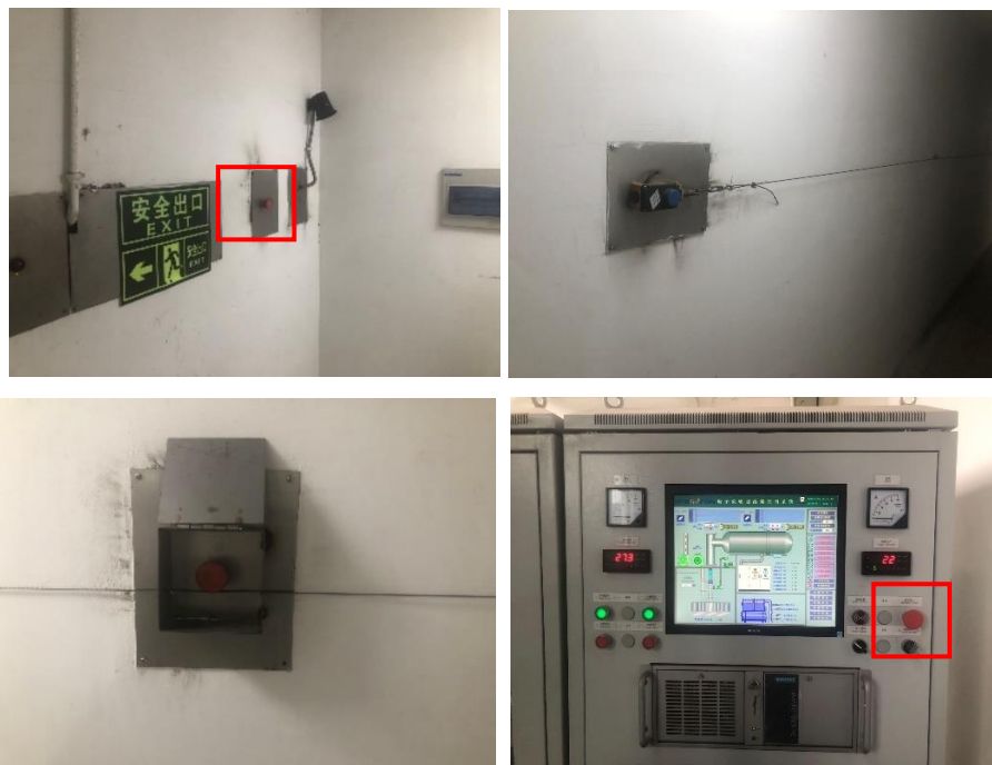
图3-8 本项目急停按钮及拉线开关装置
