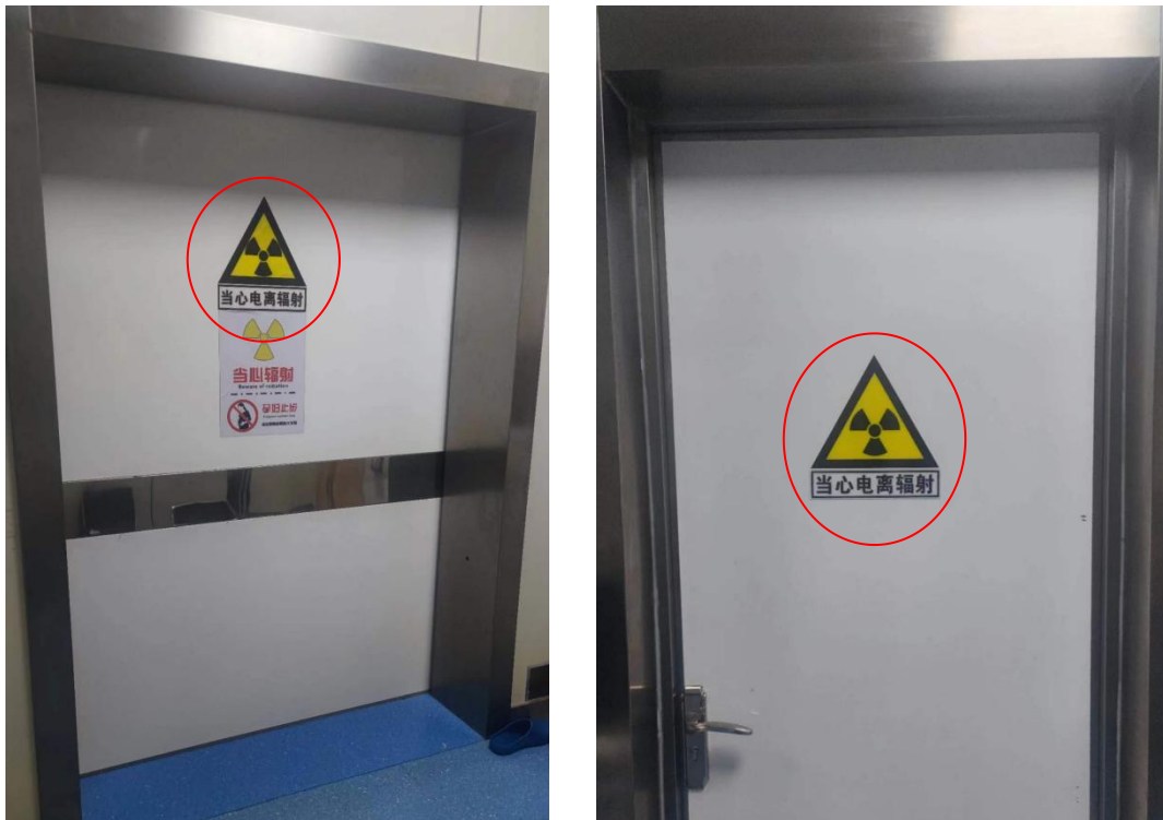
图3-3 DSA机房门上电离辐射警告标志
