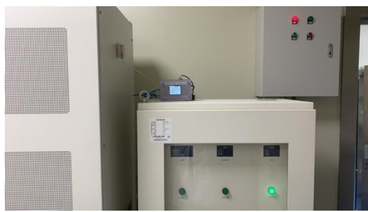
DSA机房南侧设备间
