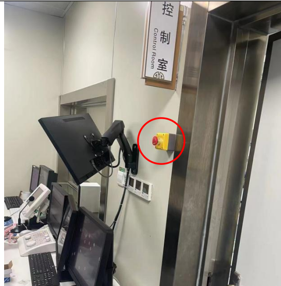
DSA控制室内急停按钮
