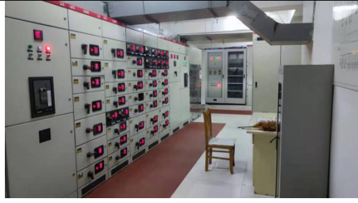
DSA机房楼下配电房
