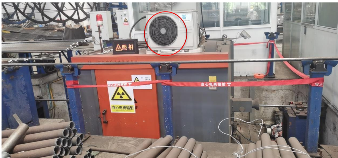
图 4-6 排风装置（空调装置）
