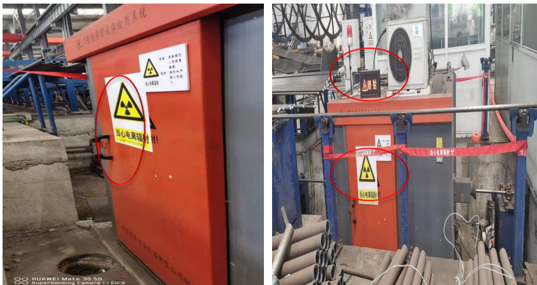
图 4-3 探伤铅房警告牌和电离辐射警告标志
