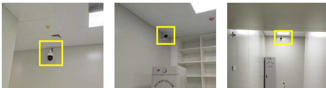
(a) 机房内监控摄像头
