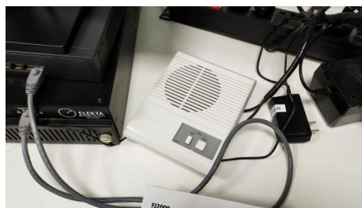
(c) 控制室内对讲装置
