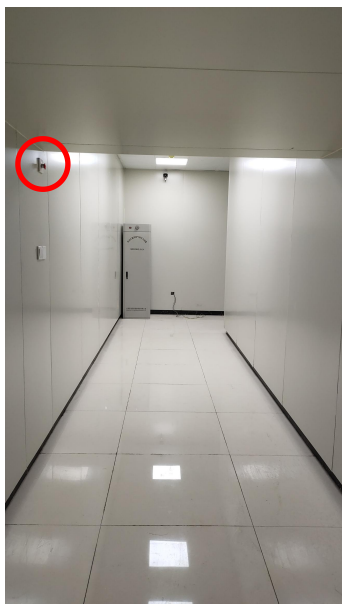
(c) 加速器机房迷道内
