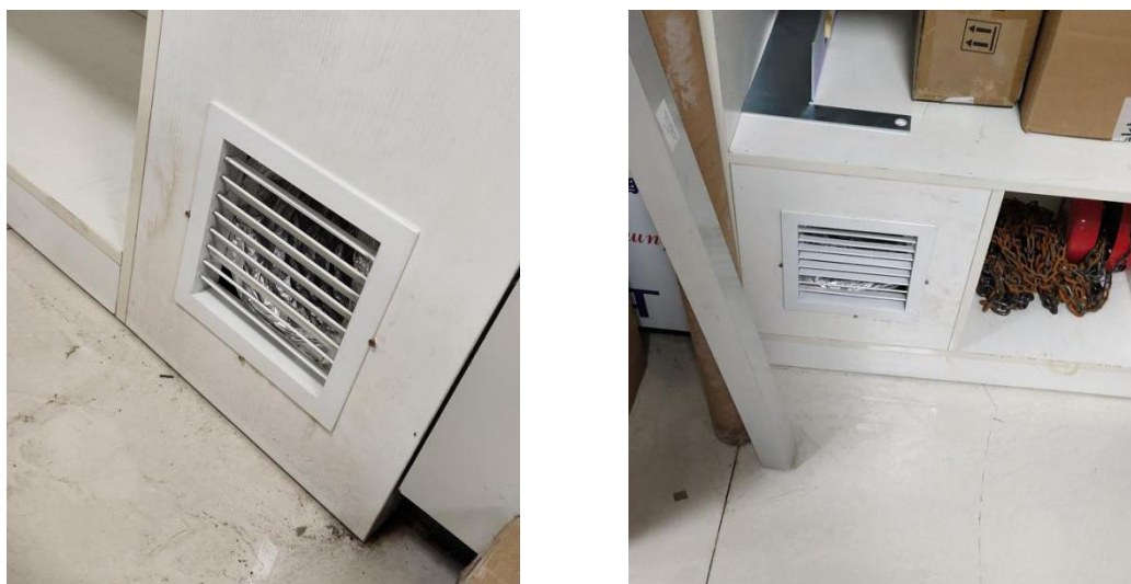
(c) 加速器机房排风口
