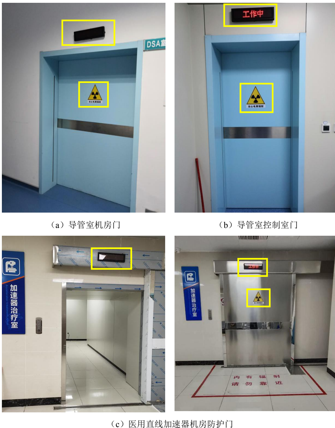
图 4-3 工作状态指示灯和电离辐射警告标志
