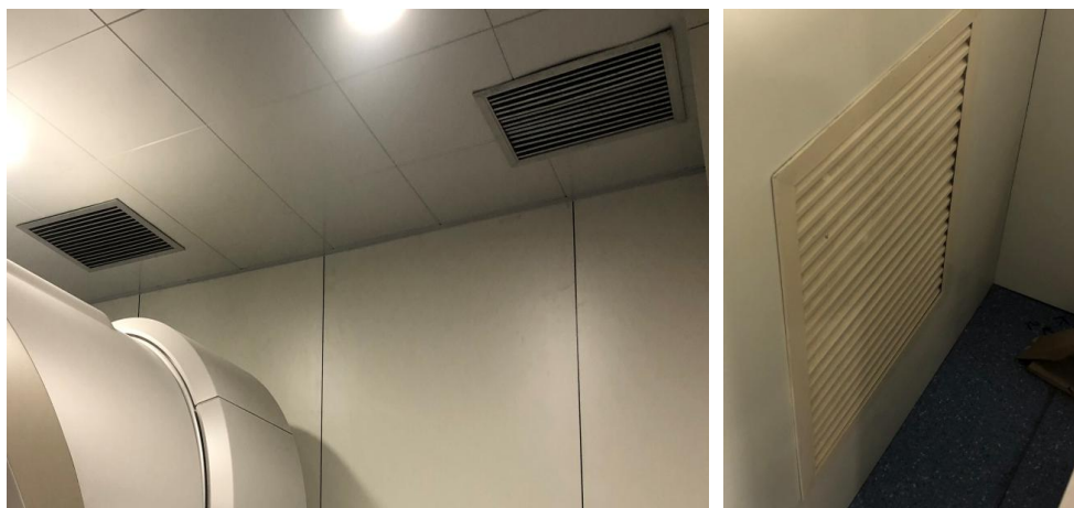
图 4-7 医用直线加速器机房新风口和排风口
