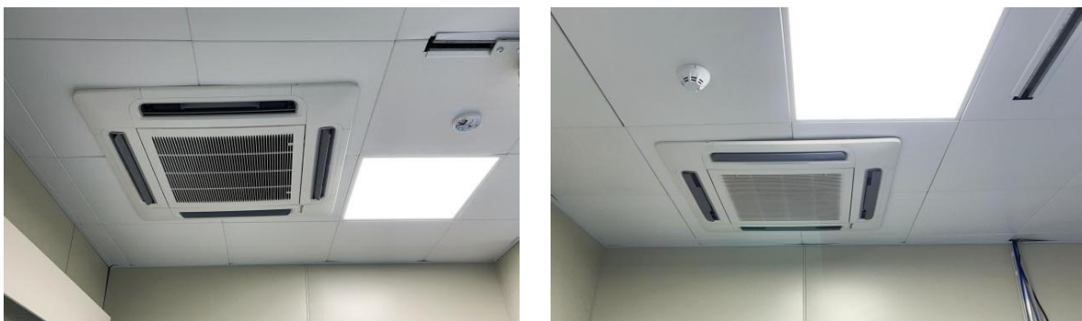
图 4-7 机房内通风装置
