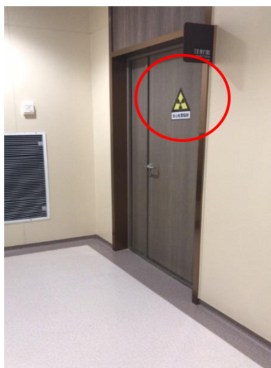
注射室防护门
