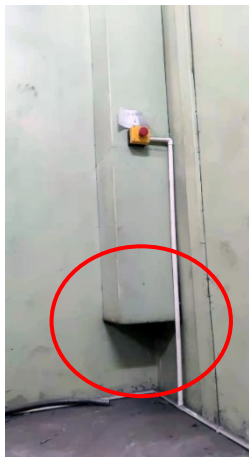
图 4-5 探伤房排风口
