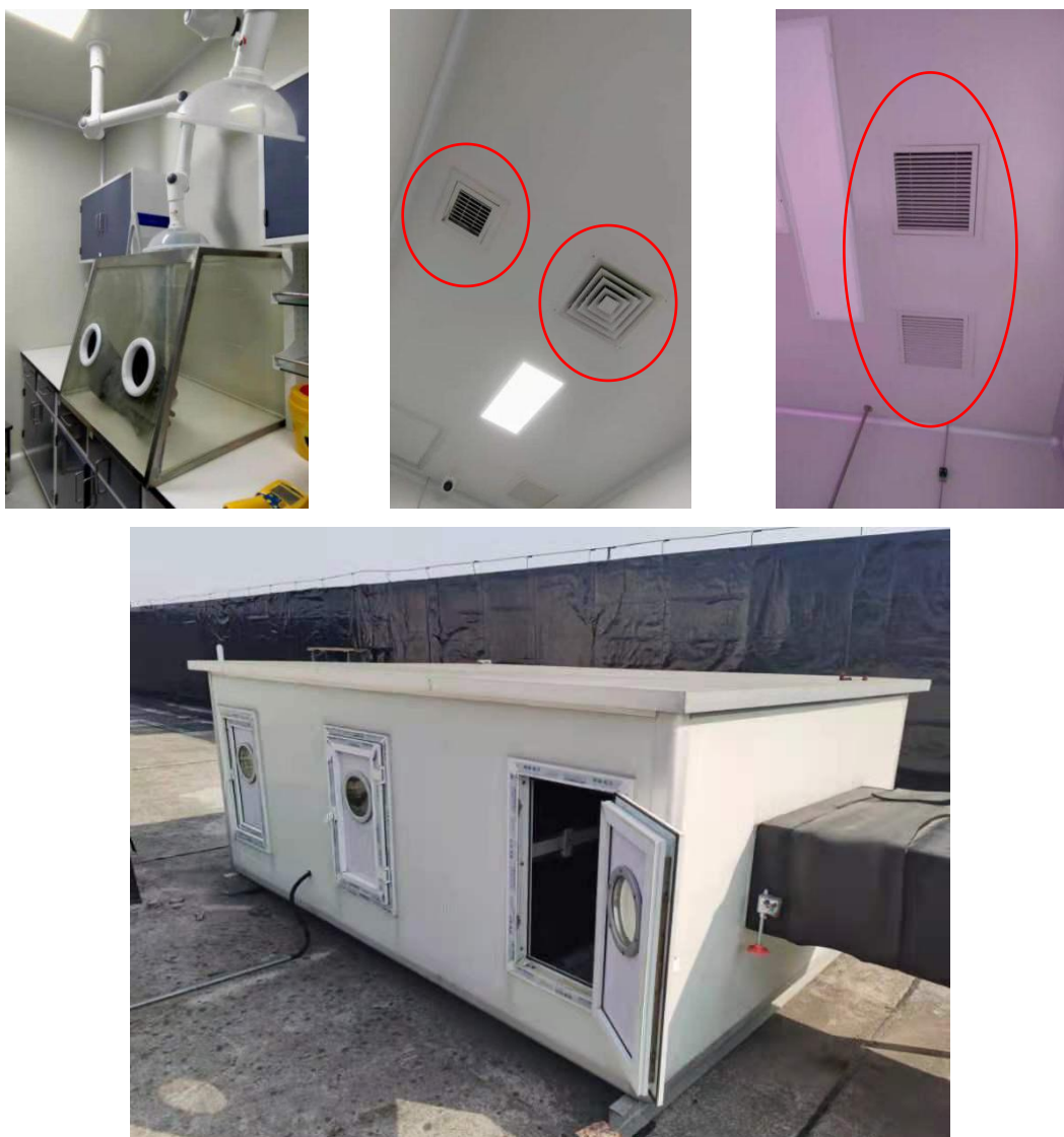
图 4-12 实验室内通风设施及楼顶排风设施
