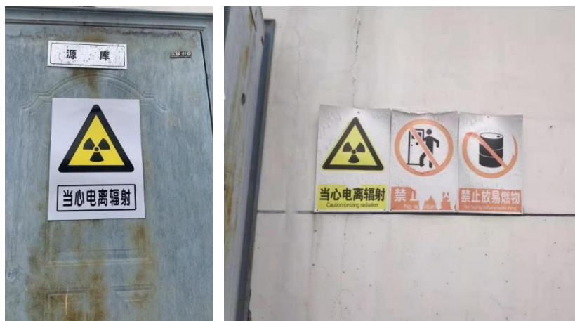
图 4-9 源库门口电离辐射警告标志
