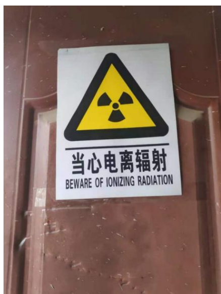
图 4-5 控制室东门上电离辐射警告标志
