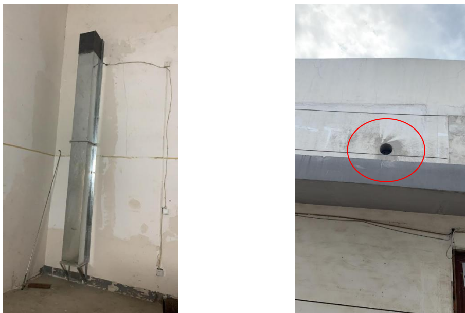
图 4-14 探伤房排风管道及出风口
