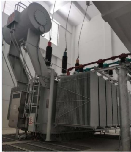
图 1-1 1#主变压器外观
