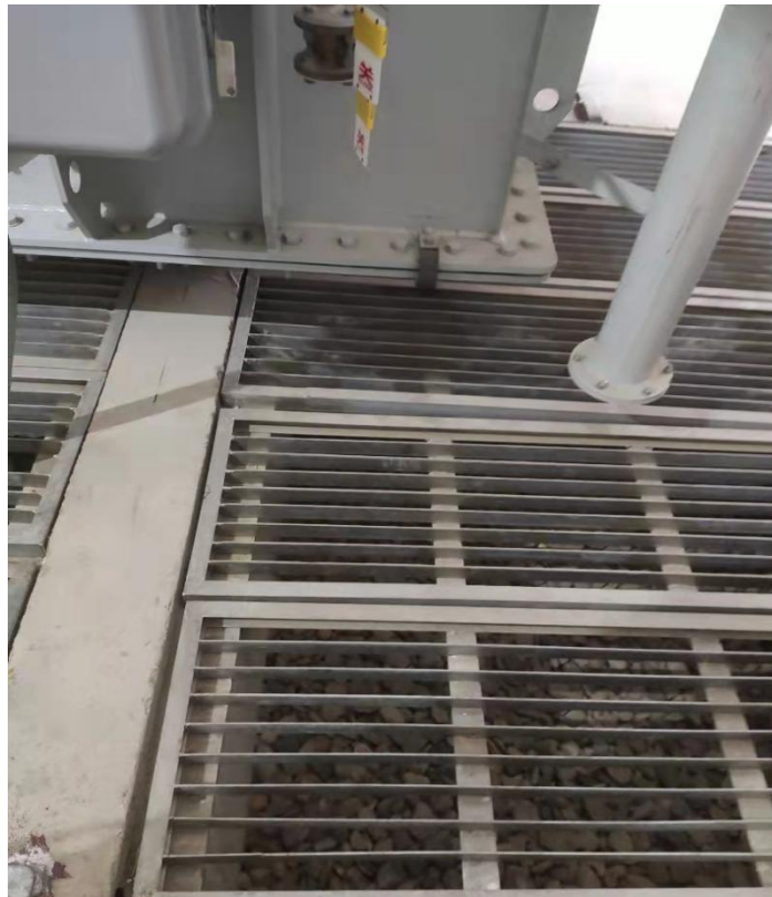
图 8-1 #2 主变下方事故油坑
