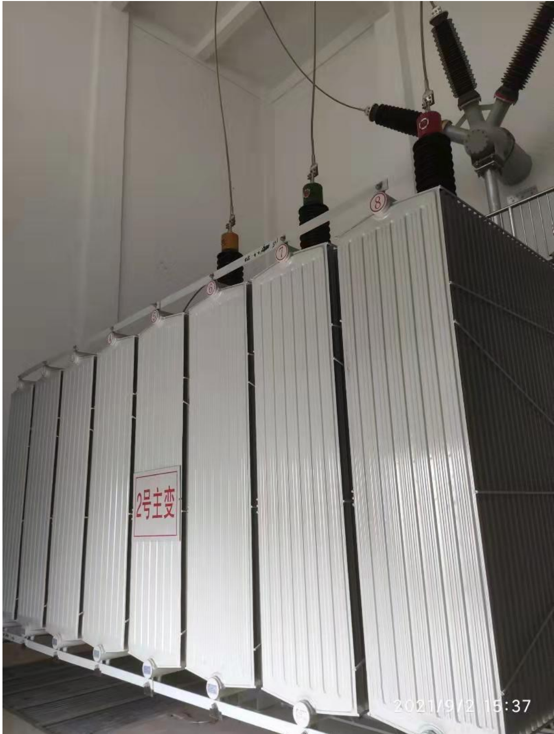
图 1-1 2#主变压器外观
