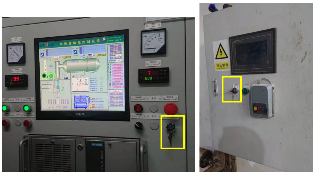
图 4-3 工业辐照加速器控制台上钥匙开关和巡检钥匙控制
