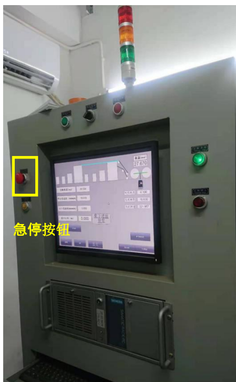
控制室束下控制系统上急停按钮
