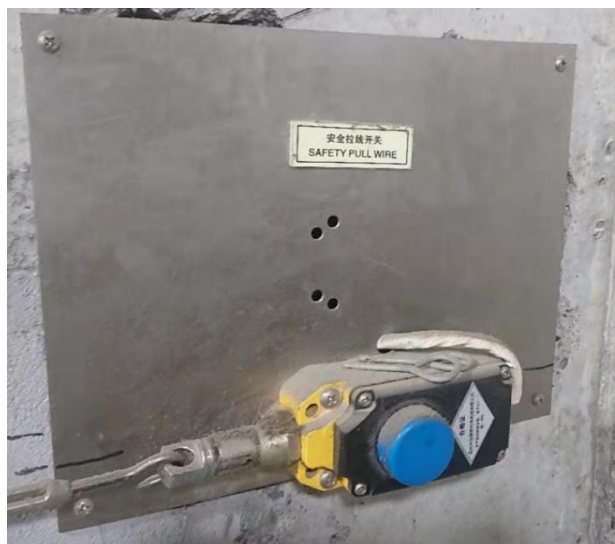
图 4-14 安全拉线装置起点处照片
