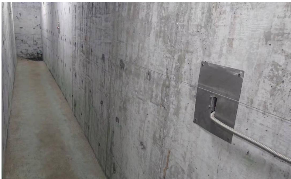
图 4-15 安全拉线装置（迷道内）照片
