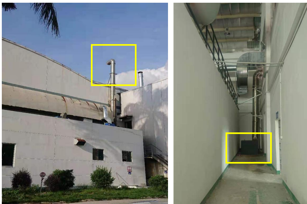
室外排风口照片
