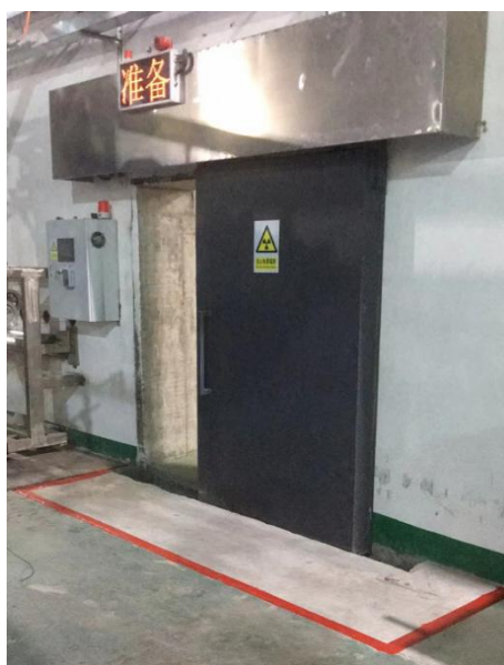
图 4-5 工业辐照加速器工作状态指示灯，地面红线和电离辐射警告标志
