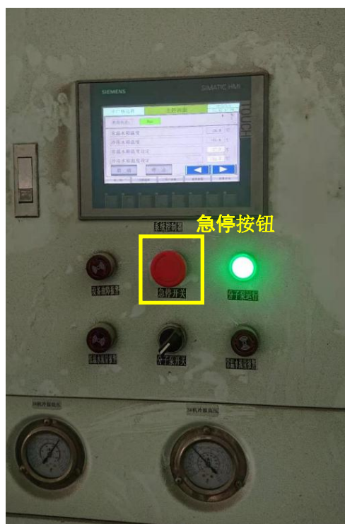
二层水冷系统上急停按钮
