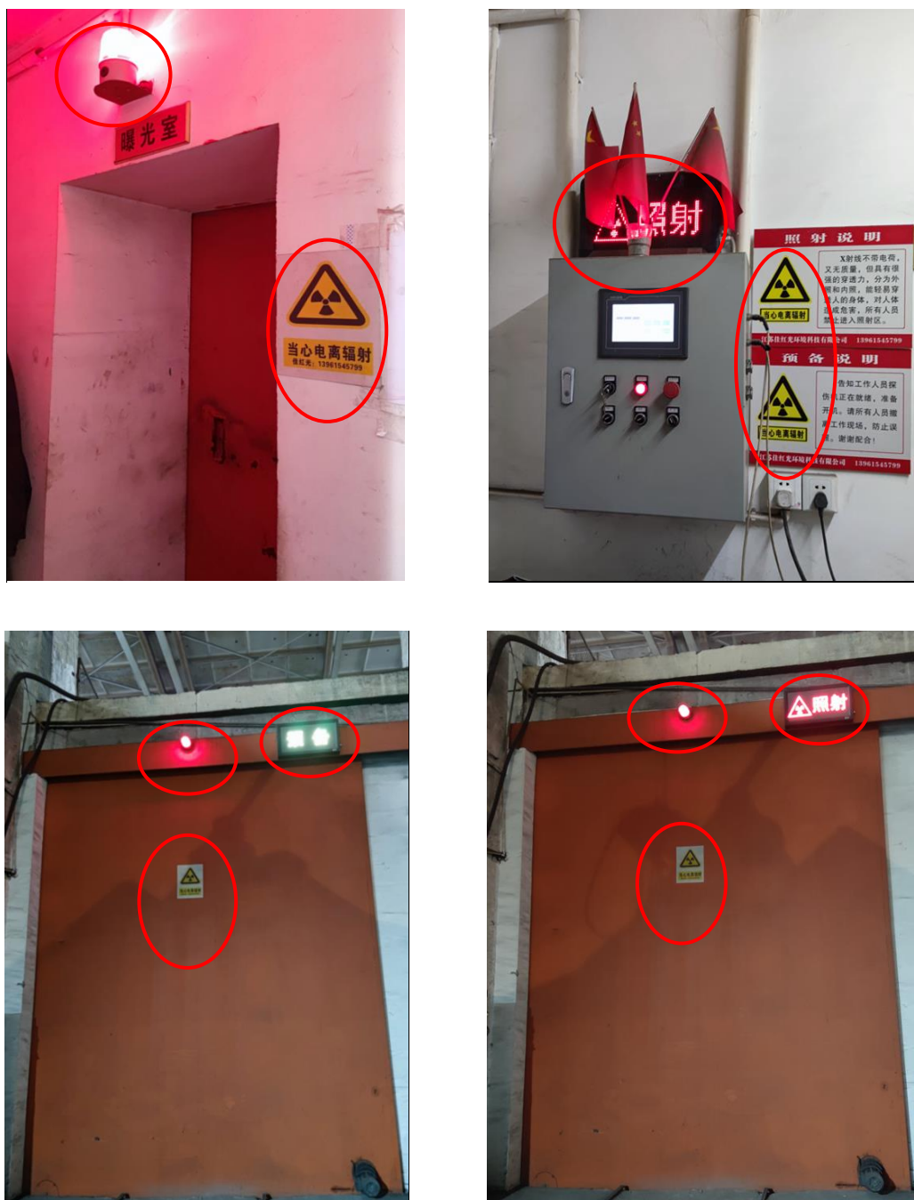
图 4-2 电离辐射警告标志及工作指示灯
