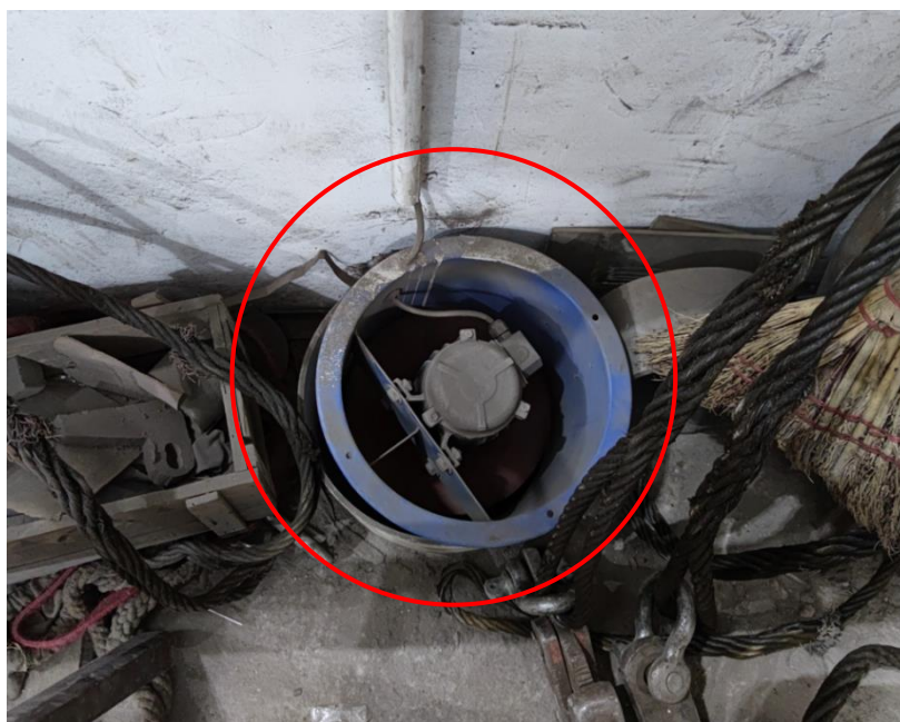
图 4-5 探伤房通风装置及排风口
