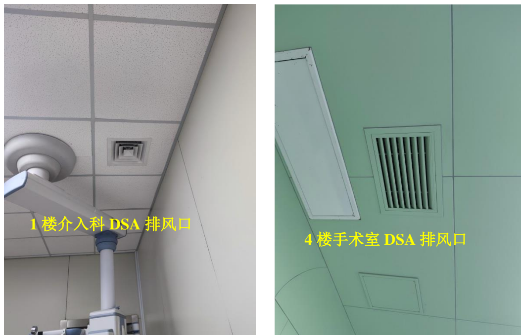
图 4-9 机房内通风装置
